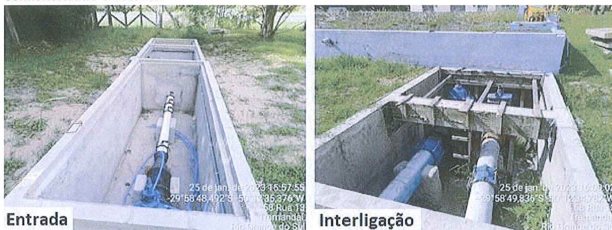
Figura 4 - Tubulação de entrada da nova adutora e interligação da ETA compacta ao reservatório semienterrado existente.
