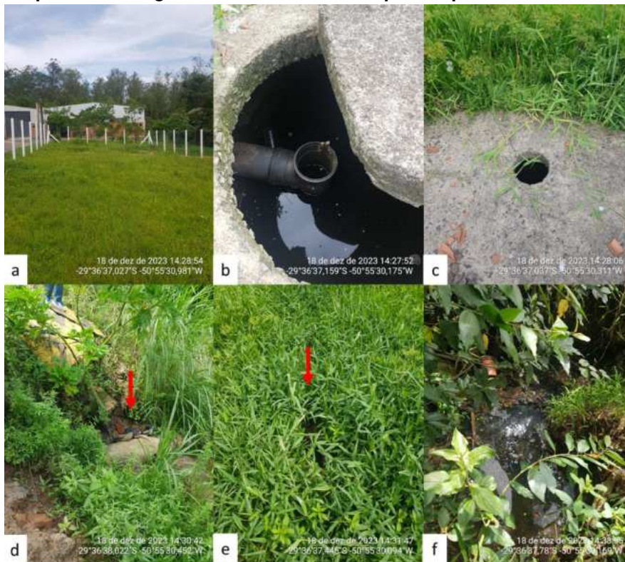
Figura 4 – Registro fotográfico da ETE da Av. Dr. Maurício Barani. a) Vista frontal da unidade; b) Vista do esgoto dentro da unidade; c) Vista de furo em na parte superior da unidade d) Vista do emissário do efluente da unidade; e) Vista de local com vazamento de efluente diretamente no solo; f) Vista do ponto de chegada do emissário no corpo receptor.
