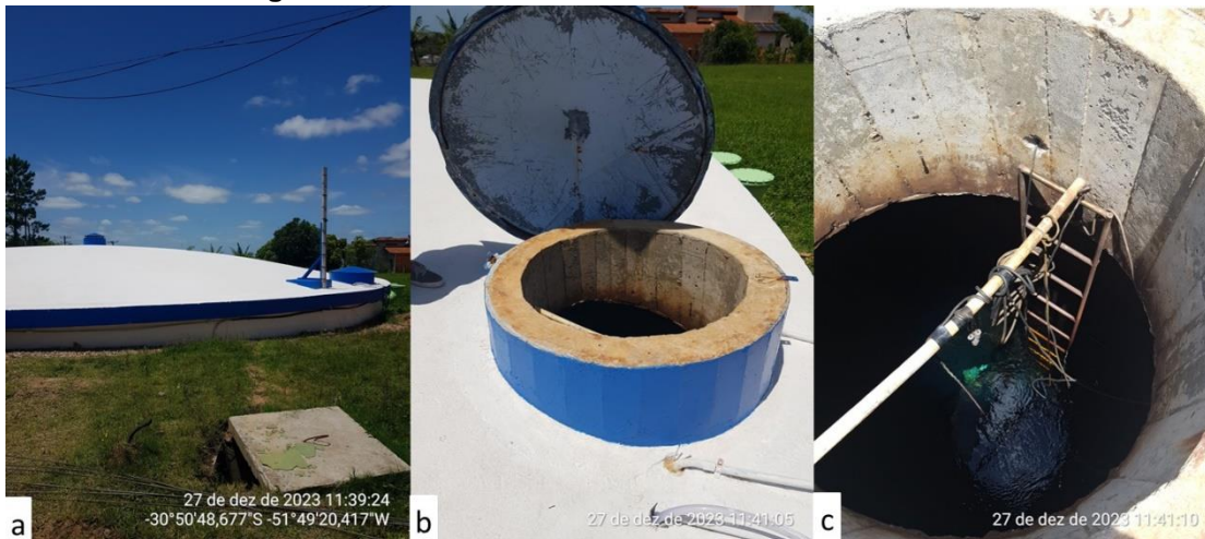
Figura 4 - Registro fotográfico do reservatório semienterrado localizado junto no parque: a) Vista geral do reservatório; b) Vista da tampa de acesso do reservatório; c) Vista interna reservatório com água.
