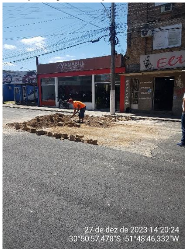
Figura 7 - Vista da obra de recomposição do pavimento na Rua Profa. Luiza Maraninchi.
