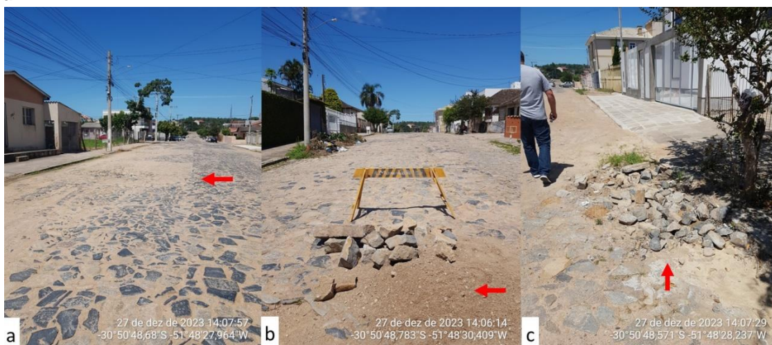
Figura 6 - Registro fotográfico dos problemas de pavimentação na Rua Dr. Walter Kess: a) Pavimentação inadequada objeto de ação do MP; b) Vista de local onde o executivo municipal enviou equipe para corrigir a pavimentação inadequada; c) Acúmulo de resíduos de obra.
