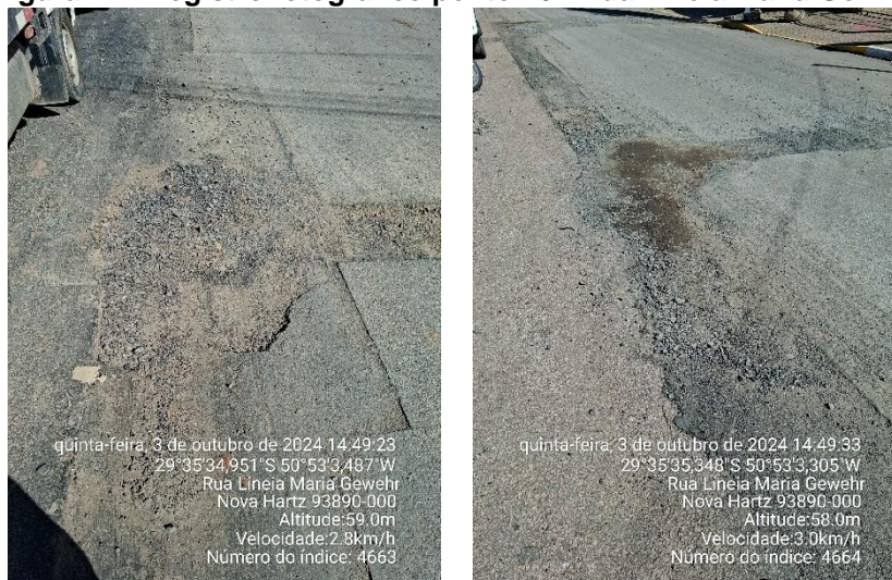
Figura 17 - Registro fotográfico ponto 16 - Rua Lineia Maria Gehwer
