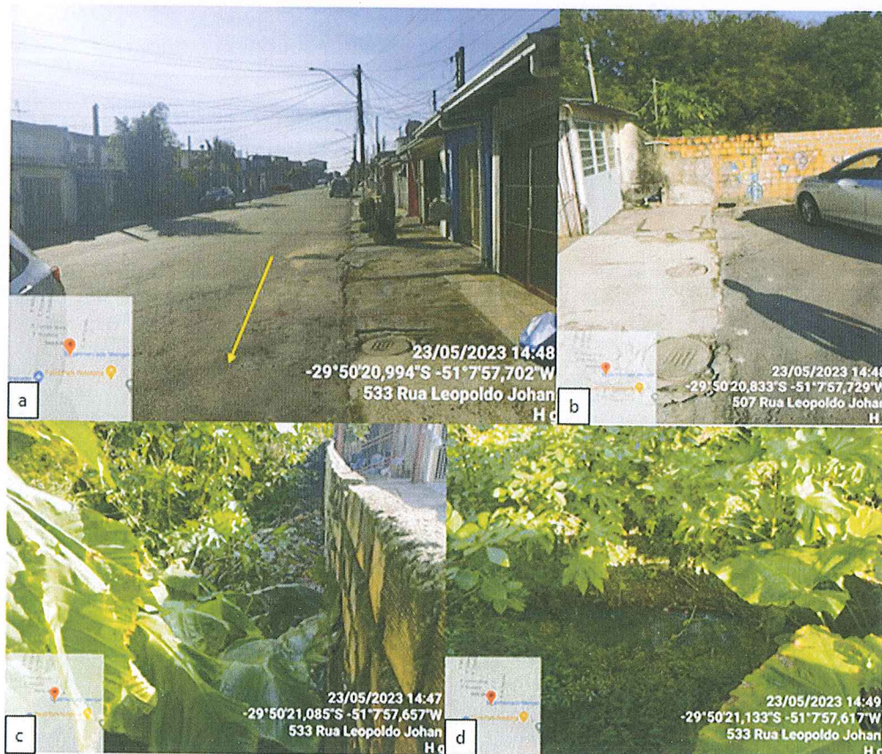
Figura 2 – Registros fotográficos: a) Caimento da rede coletora de esgoto em direção ao muro do final da rua; b) Caixa de ligação de esgoto das residências locais; c) Entulho que impede a visualização da rede de esgoto; d) Córrego com mau cheiro e sinais de esgoto in natura .
