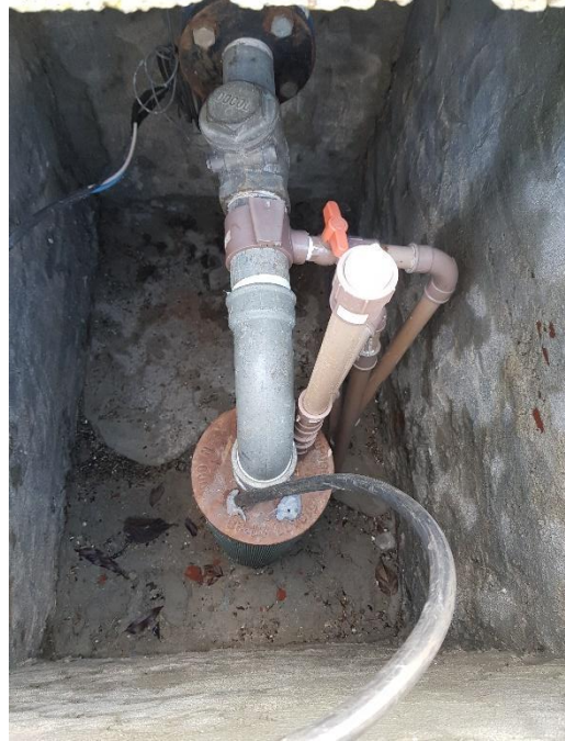
Figura 2f – Caixa de proteção (vista interna) com laje de proteção, ponta do tubo de revestimento do poço em PVC (azul), barrilete em FºFº com válvula de retenção.
