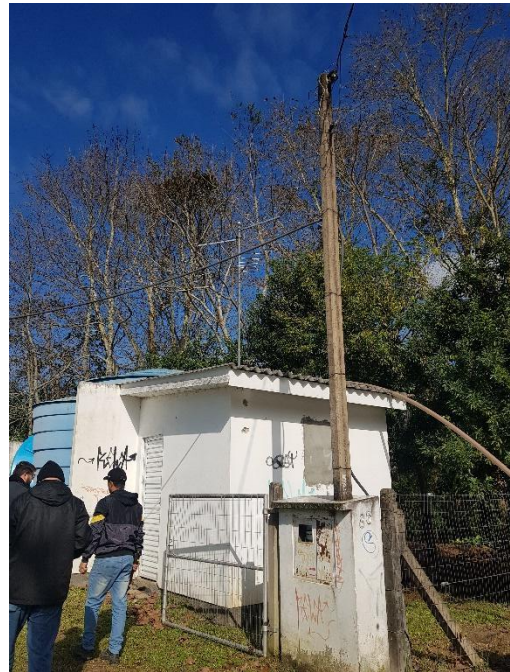
Figura 12b – Casa de Bombas, Cercamento e Padrão de Energia.
