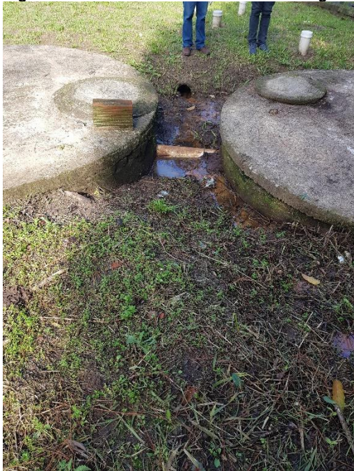
Figura 17c – Possível Extravasamento de Esgoto.
