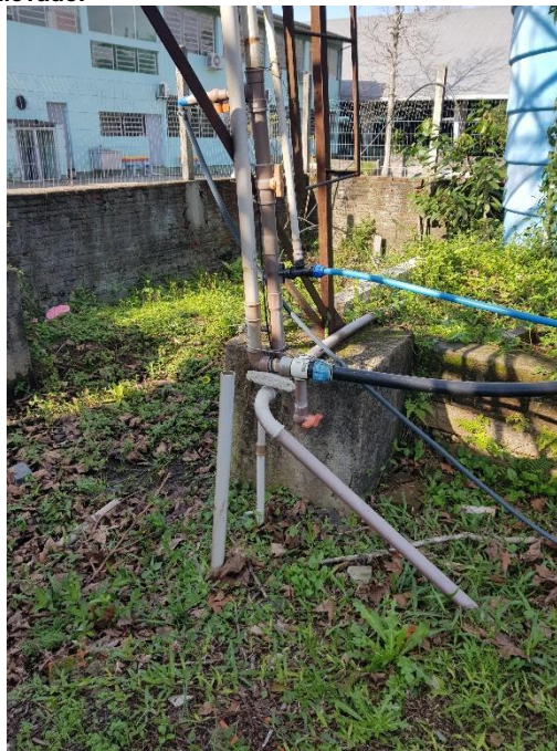
Figura 11f – Tubulações e Conexões do Reservatório Elevado.
