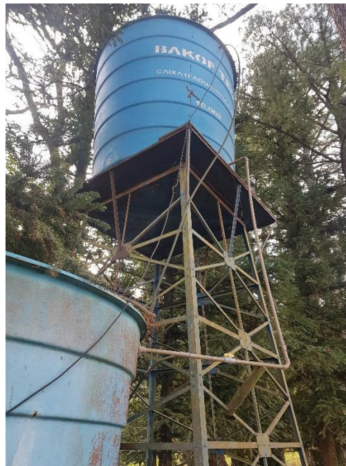
Figura 9b – Tubulação de Alimentação do Reservatório Apoiado em PVC e Torre Metálica do Reservatório Elevado.
