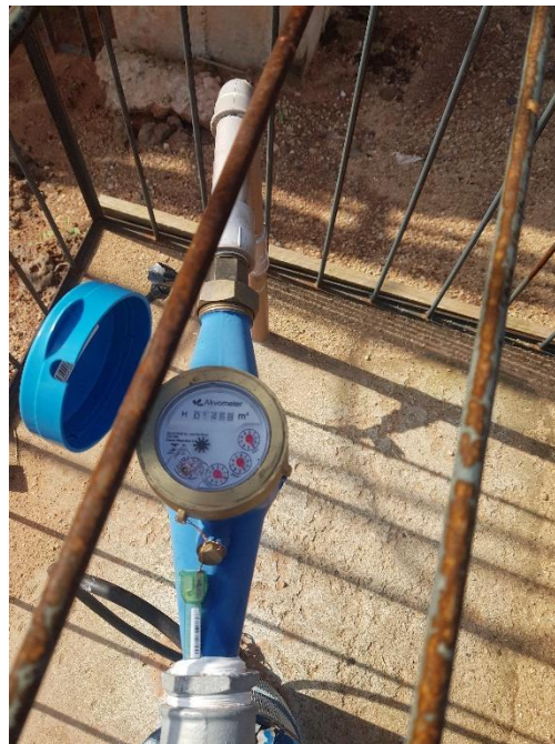
Figura 8b – Macromedidor na saída do poço, Loteamento Azaleias.
