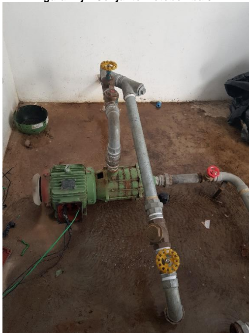
Figura 12j – Conjunto Motobomba 02.
