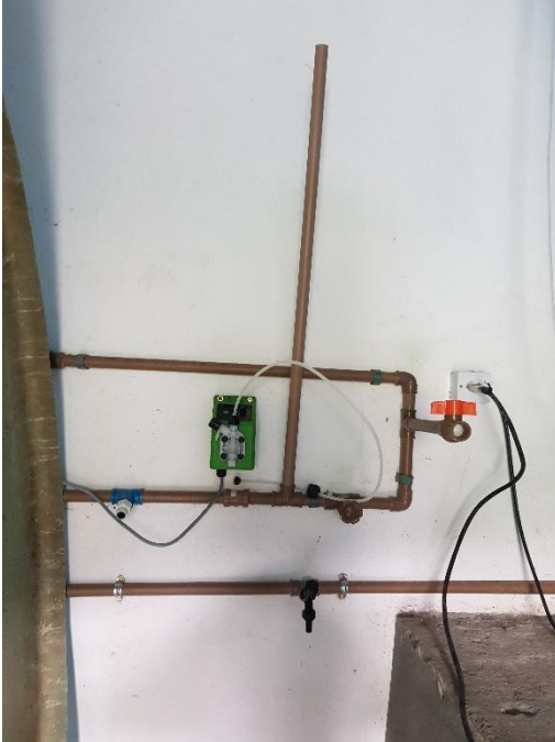
Figura 2i – Bomba e barrilete de dosagem de produtos químicos.
