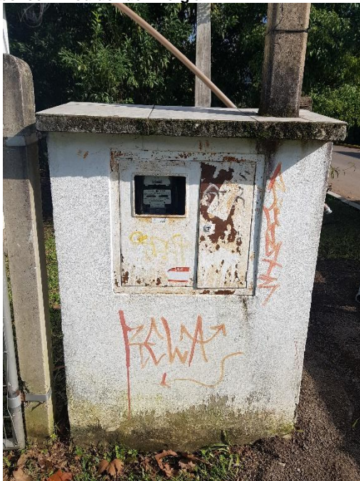
Figura 12c – Padrão de Energia da Edificação do Campo de Futebol com Medidor de Energia.
