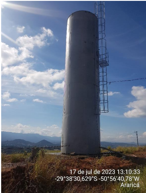
Figura 10a – Reservatório Metálico do Loteamento Bela Vista com escada protegida.
