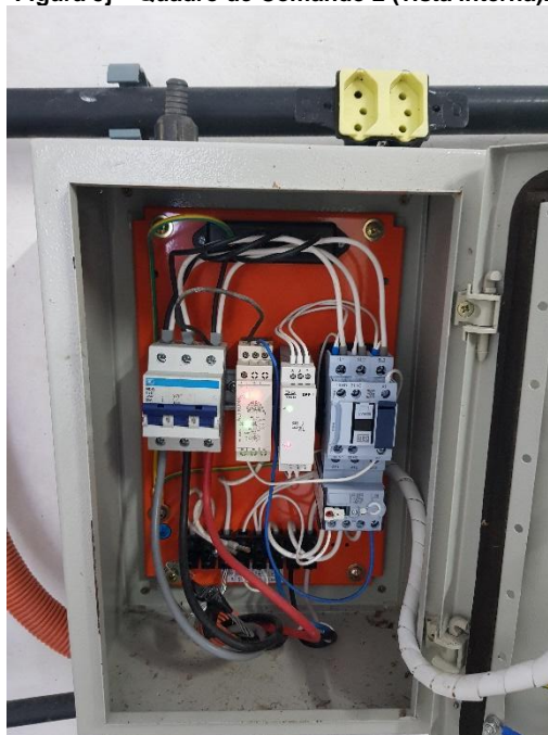
Figura 5j – Quadro de Comando 2 (vista interna).
