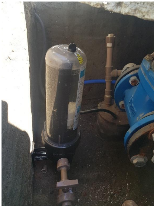
Figura 6d – Caixa de proteção do poço (vista interna), com novo sistema de desinfecção.
