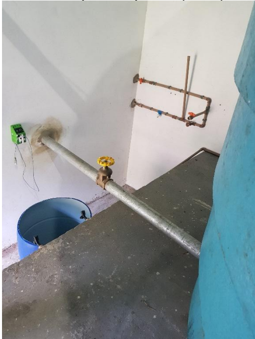
Figura 1i – Casa de apoio (vista interna), tubulação de saída FºFº com registro, reservatório em fibra (direita), barrilete e bomba dosadora de produtos químicos (fundos).
