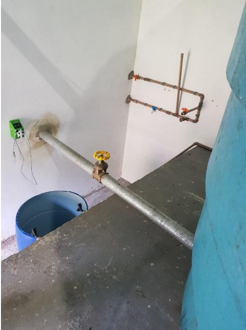
Figura 1k – Bomba e barrilete de dosagem de produtos químicos.
