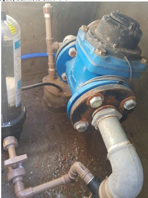
Figura 6c – Caixa de proteção do poço (vista interna), ponta do tubo de revestimento em PVC (azul), com laje de proteção, barrilete em FºFº.
