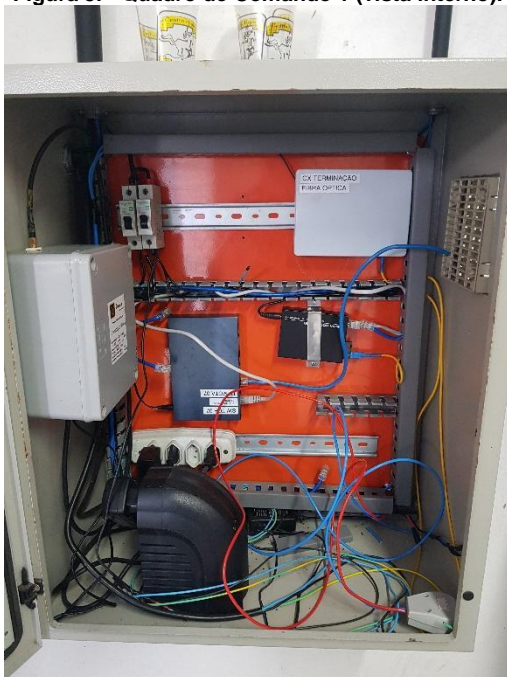
Figura 5i - Quadro de Comando 1 (vista interno).
