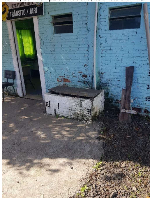
Figura 6h – Caixa de proteção da elevatória EE-5 (vista externa) com tampa de madeira, barrilete em PVC.
