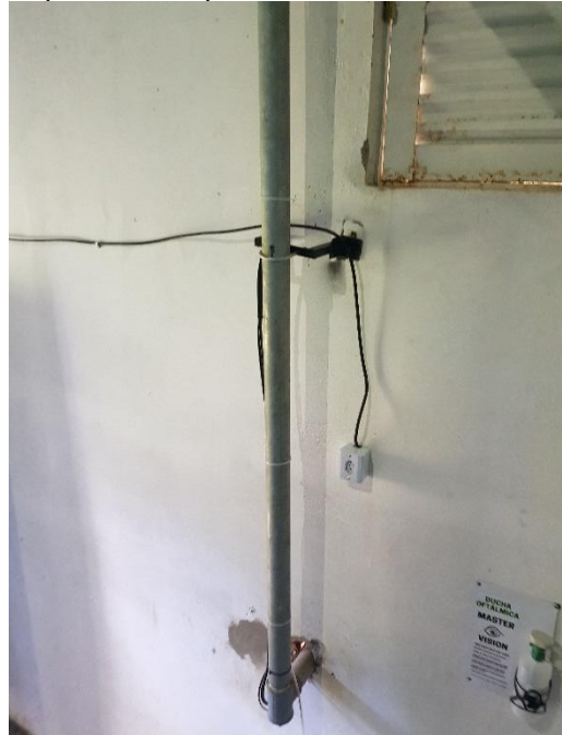
Figura 1j – Barrilete em FºFº (seta azul), entre a caixa de proteção e casa de apoio, tubulação de saída em FºFº (seta vermelha).
