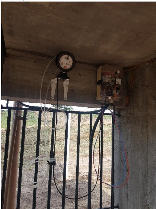
Figura 8c – Bomba dosadora de produtos químicos e Quadro de Comando.
