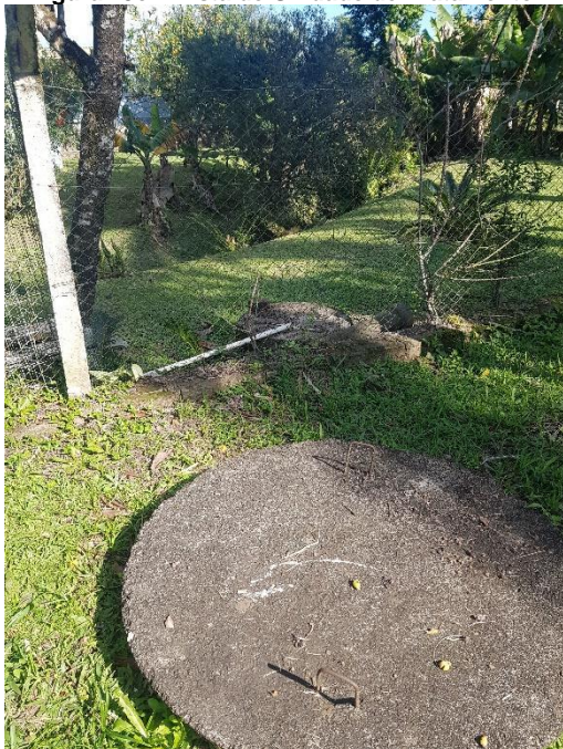
Figura 19c – Vista de Unidade de Tratamento.
