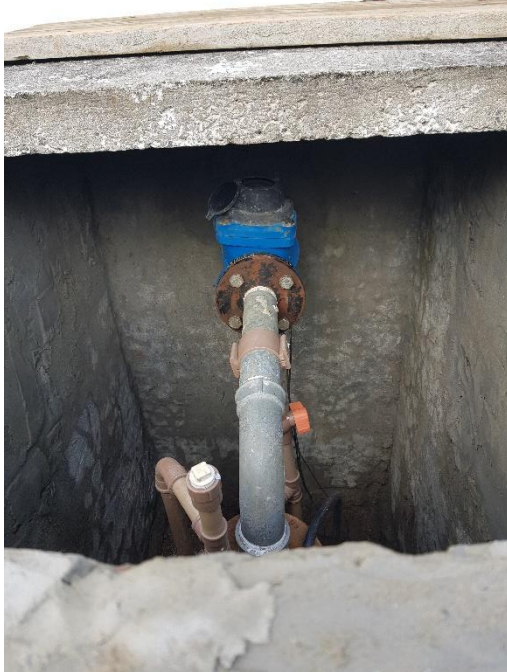
Figura 1g – Abrigo do poço P-4 (vista interna), macromedidor e válvula de retenção (concretada na caixa).
