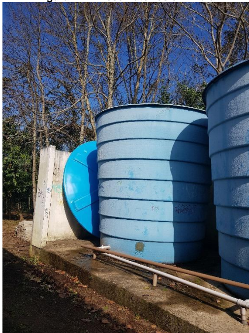
Figura 12l – Reservatórios em Fibra.
