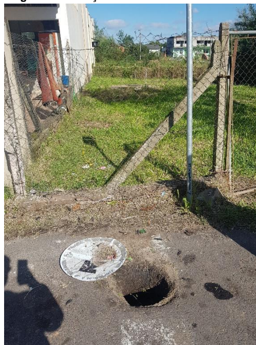
Figura 13b – Poço de Visita de Entrada da ETE.
