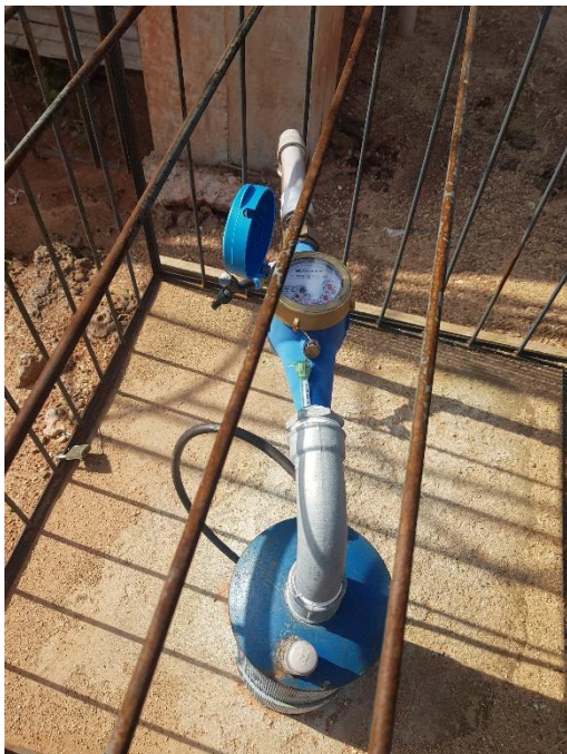
Figura 8a – Poço Loteamento Azaleias, tubulação de revestimento em PVC (azul), barrilete em FºFº, macromedidor. Flúor fora da norma.
