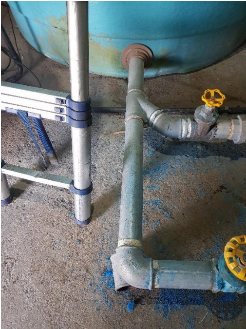
Figura 2k – Barrilete de sucção em FºFº, saindo do reservatório.
