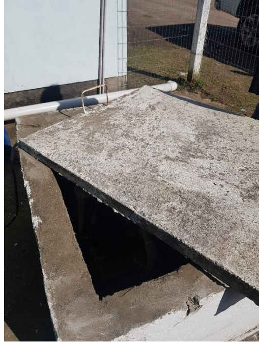
Figura 6b – Caixa de proteção do poço (vista externa).
