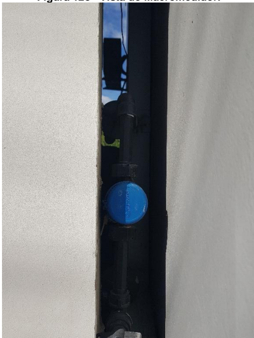
Figura 12o – Vista do Macromedidor.
