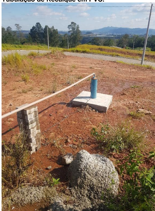
Figura 10d – Ponta do Tubo de Revestimento do Poço em PVC (azul) com Laje de proteção, Barrilete em F9F e Tubulação de Recalque em PVC.
