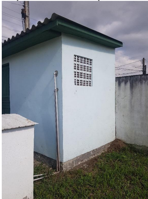
Figura 4d – Casa de Apoio (vista lateral) com tubulação do sistema de desinfecção.
