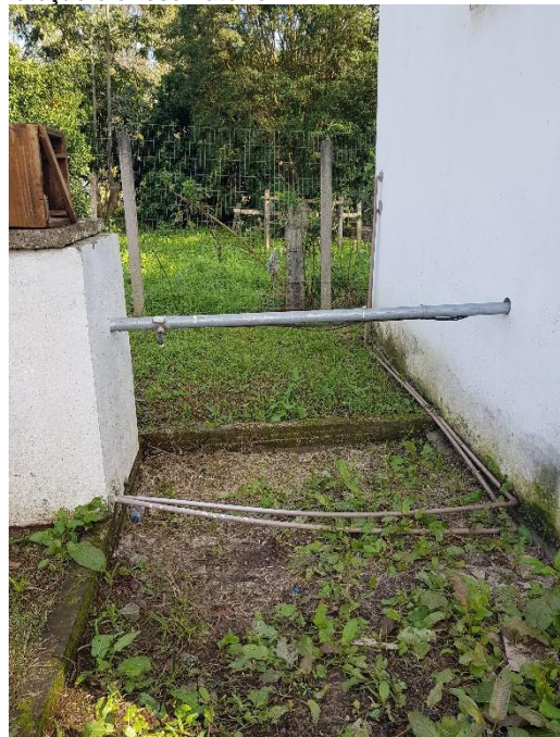
Figura 2h – Barrilete em FºFº, entre a caixa de proteção e o reservatório R1.
