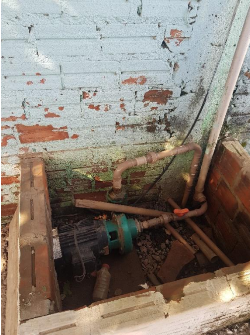
Figura 6i – Elevatória EE-5 – motobomba de recalque para o bairro.
