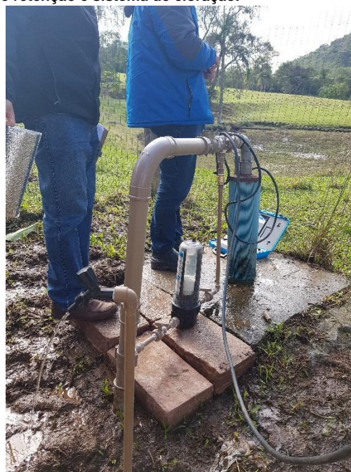
Figura 7b – Ponta do tubo de revestimento do poço em PVC (azul) com laje de proteção, barrilete, válvula de retenção e sistema de cloração.
