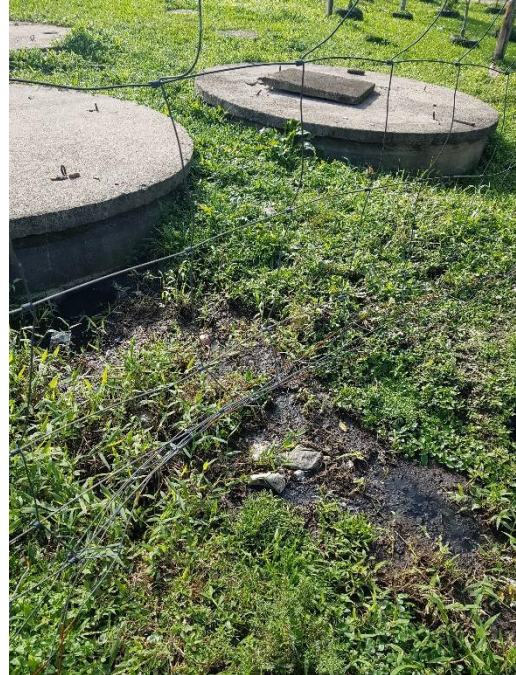
Figura 16d – Extravasamento de Esgoto.
