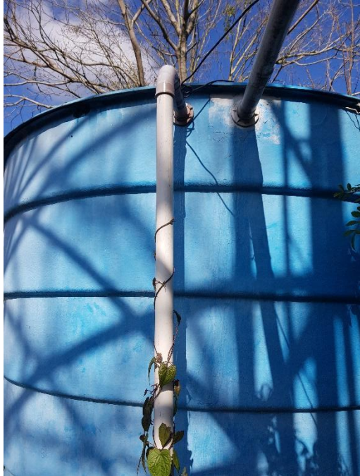
Figura 11d – Reservatório Apoiado em Fibra e Tubulações.
