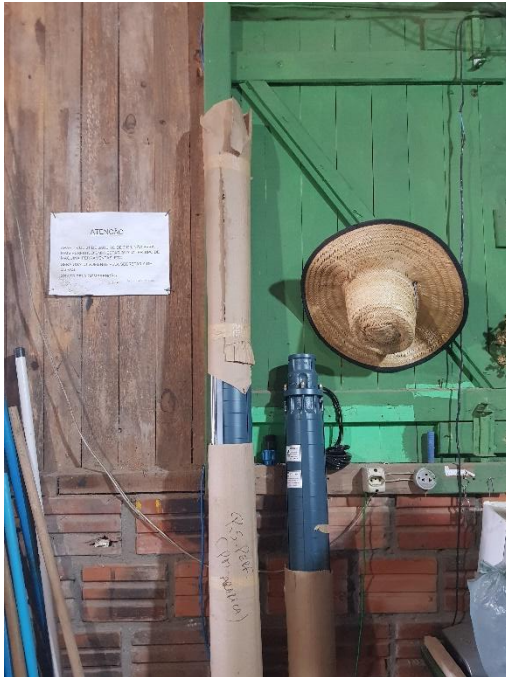
Figura 20a – Bomba para Poço Tubular.
