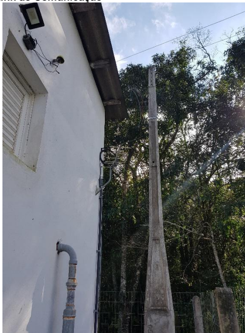
Figura 2d – Poste do medidor de Energia e Antena do Link de Comunicação
