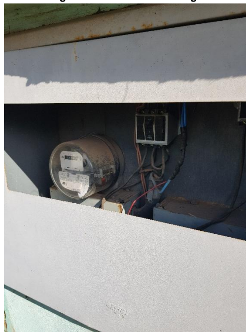
Figura 3b – Medidor de energia
