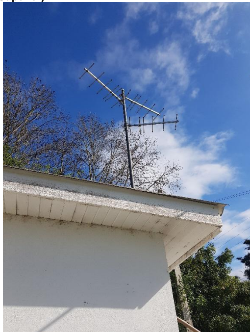
Figura 12d – Casa de Bombas, Link de Comunicação (Superior).
