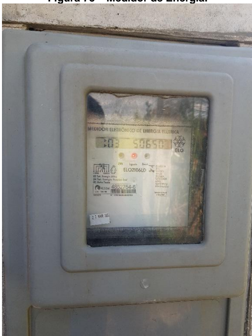
Figura 7c – Medidor de Energia.
