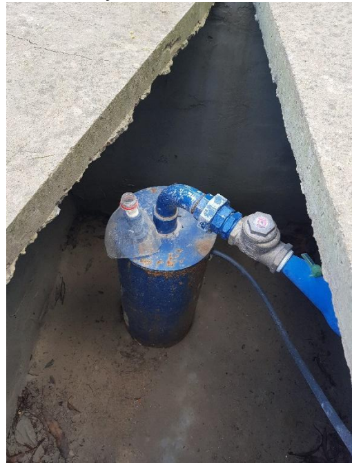
Figura 5b – Caixa de Proteção do Poço P-2 (vista interna), ponta do tubo de revestimento do poço em PVC (azul) com laje de proteção, barrilete em FºFº com válvula de retenção.
