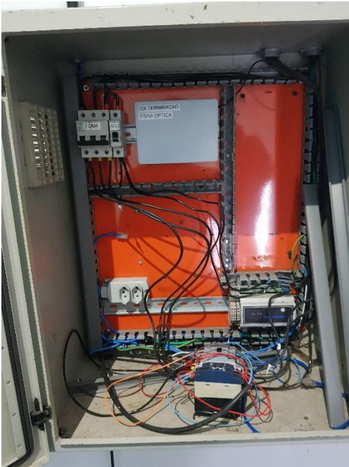
Figura 1m – Quadro de comanda (vista interna), fora das normas técnicas.
