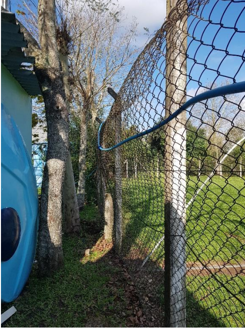
Figura 11a – Tubulação que alimenta o Reservatório Apoiado.
