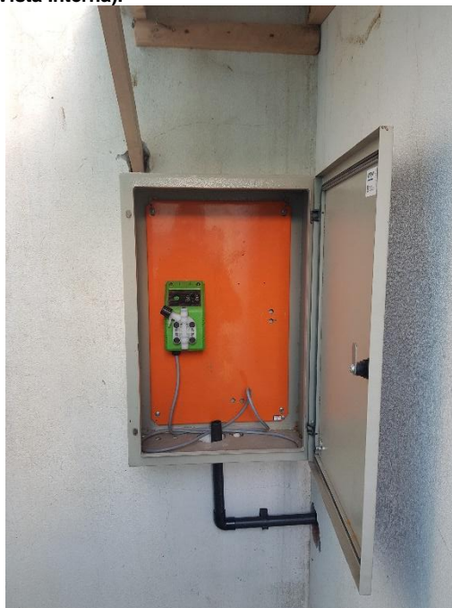
Figura 12n – Caixa de Proteção da Bomba Dosadora (Vista Interna).
