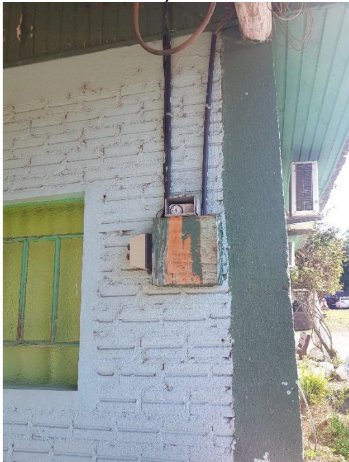
Figura 6m – Quadro de Comando Alternativo 2 (dentro da sede da Secretaria de Obras).
