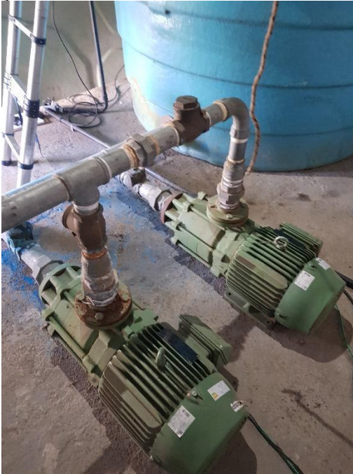
Figura 2m – Barrilete de recalque em F 0 F 0 e válvulas de retenção.
