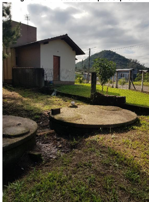
Figura 17b – Vista dos Tanques Sêpticos.
