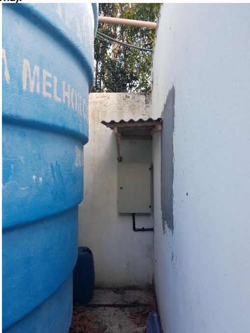
Figura 12m – Caixa de Proteção da Bomba Dosadora (Vista Externa).
