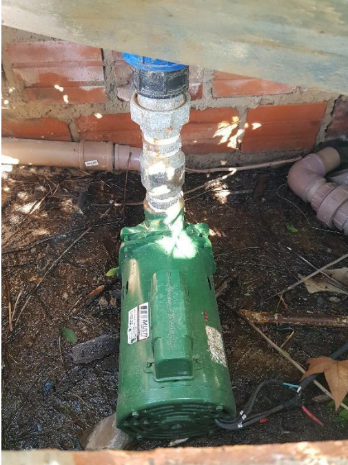
Figura 11c – Motobomba da EE-EMEI (Abastecer o Reservatório Elevado), Fiação em Estado Precário.
