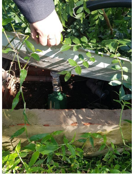
Figura 11b – Caixa de Proteção da Elevatória EE-EMEI.
