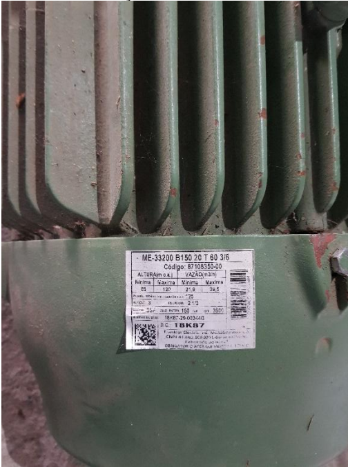
Figura 2o – Identificação das características da bomba 1.
