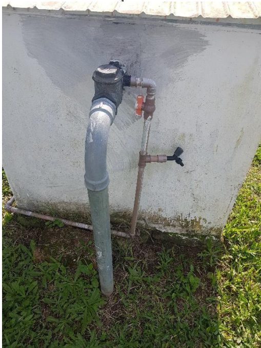
Figura 4c – Caixa de proteção do poço (vista externa) com barrilete e Válvula de Retenção.
