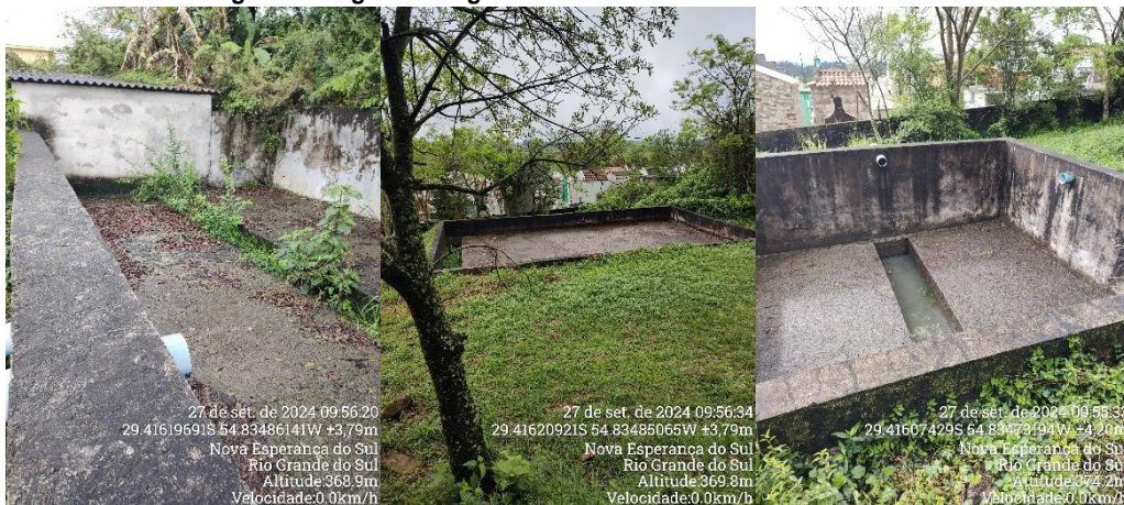
Figura 3 –Registro fotográfico de unidade de tratamento de lodo
