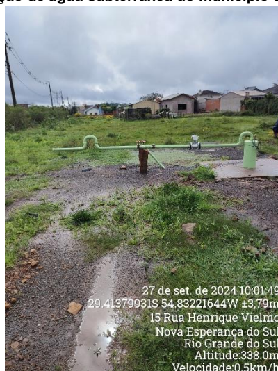
Figura 1 – Poço de captação de água subterrânea do município de Nova Esperança do Sul.
