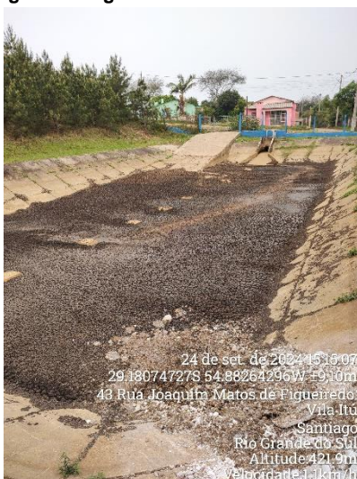
Figura 4 – Registro fotográfico de unidade de tratamento de lodo
