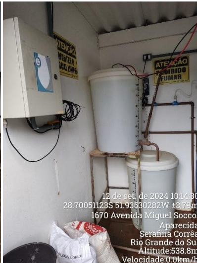
Gerador de cloro e reservatório de solução de cloro a ser dosada no sistema.
