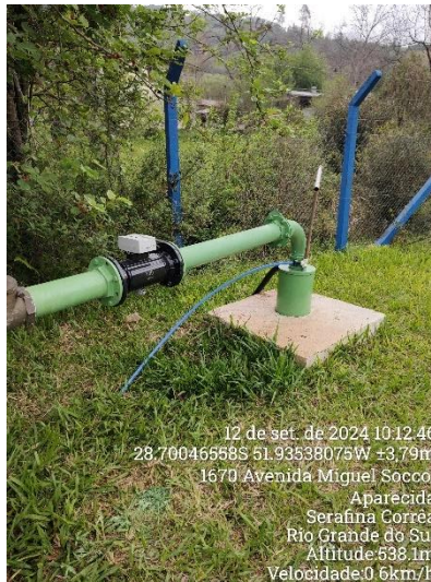
Vista do poço com macromedidor.
