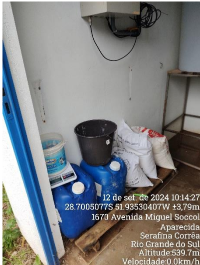
Acondicionamento de sacos de sal para utilização no gerador de cloro.
