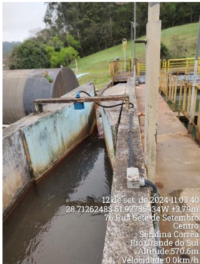
Entrada da água na ETA, macromedidor na calha Pashal para medição de vazão.
