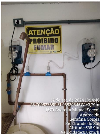
Bombas dosadoras de solução de cloro e flúor.
