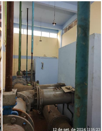
Tanques de contato para desinfecção.
