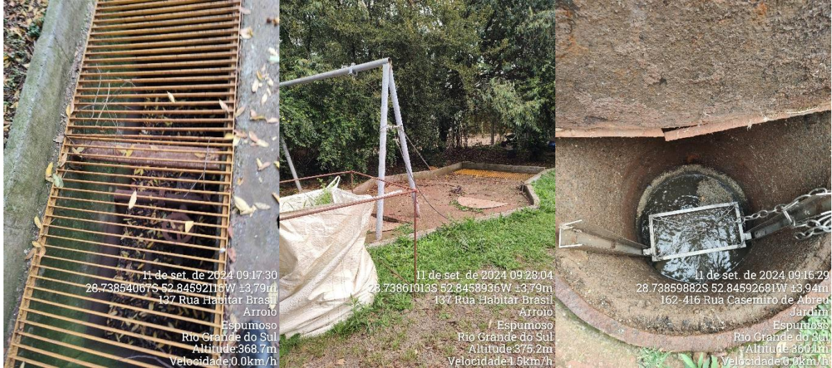
Figura 11 – Estrutura da EBE do SES.
