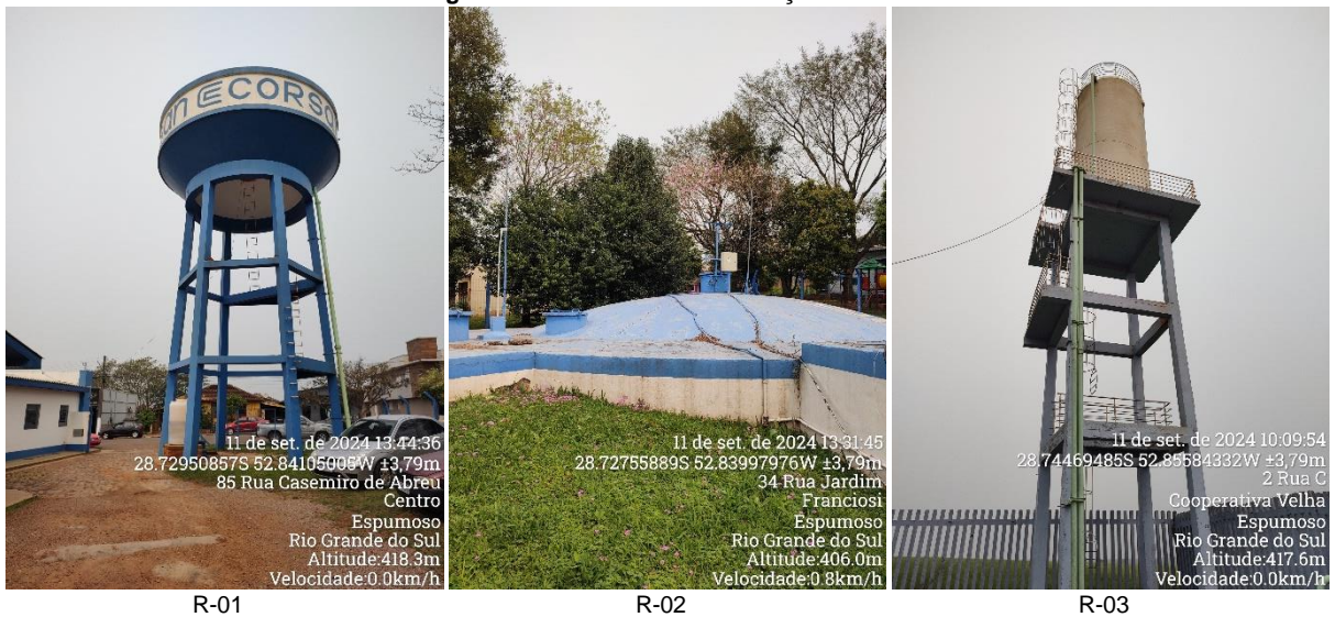
Figura 9 – Estruturas de reservação do SAA
