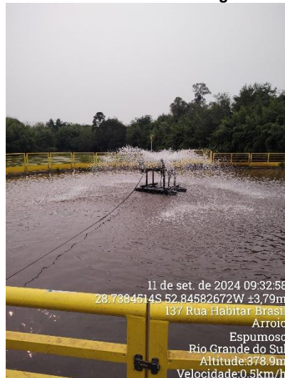
Figura 12 – Estrutura da unidade de tratamento de esgoto sanitário fiscalizada do SES.
