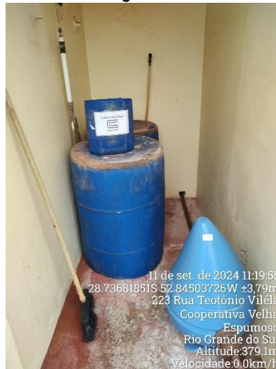
Figura 5 – Tratamento simplificado realizado no sistema de abastecimento pela utilização de “gota”.
