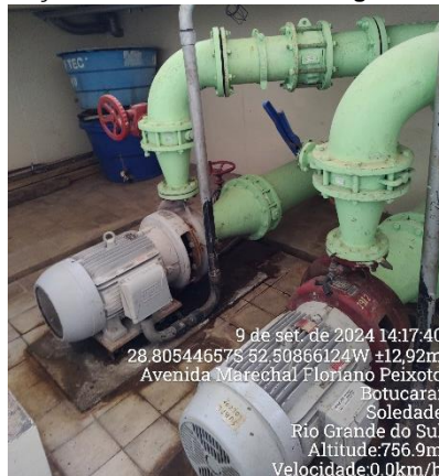
Figura 8 – Estações de Bombeamento de Água Tratada do SAA.
