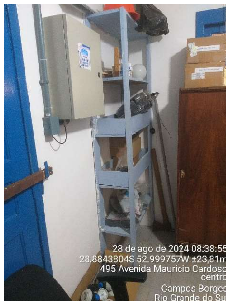
Figura 11 - Unidade comercial - Armário secundário.
