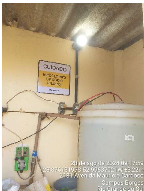
Figura 5 - Interior da Casa de Química simplificada do poço CBO 07.
