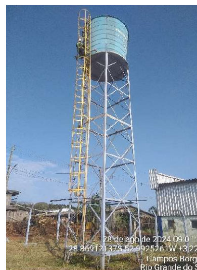
Figura 9 - Reservatório R3 Capacidade: 15 m 3 - PRFV
