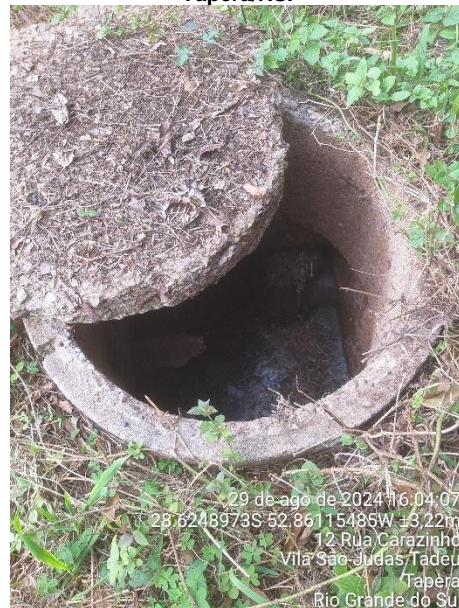
Figura 21 - Caixa de inspeção referente a condução dos efluentes para fossa séptica coletiva na Vila Brasília - Tapera/RS.
