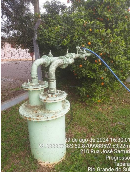
Figura 12 - Sistema de Bombeamento Compacto - Recalque (REC).
