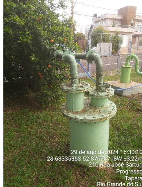
Figura 13 - Sistema de Bombeamento Compacto - Recalque (REC).
