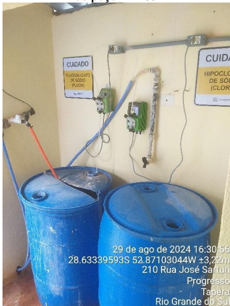
Figura 10 - Interior da Casa de Química simplificada do poço TAP 03.
