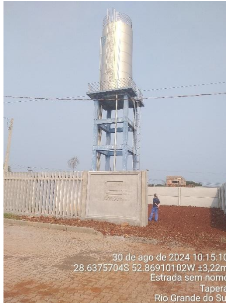
Figura 19 - Reservatório sem denominação em aço inox no município de Tapera/RS.
