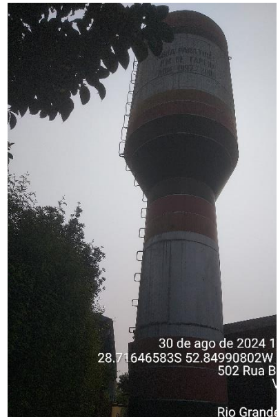
Figura 18 - Reservatório R6 Capacidade: 10 m 3 - Metálico.
