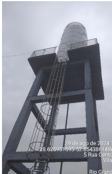
Figura 17 - Reservatório R5 Capacidade: 70 m 3 - Metálico
