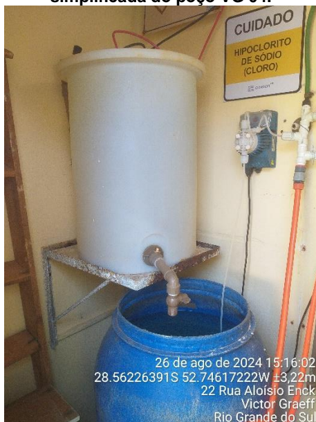
Figura 5 - Interior da Casa de Química simplificada do poço VG 04.
