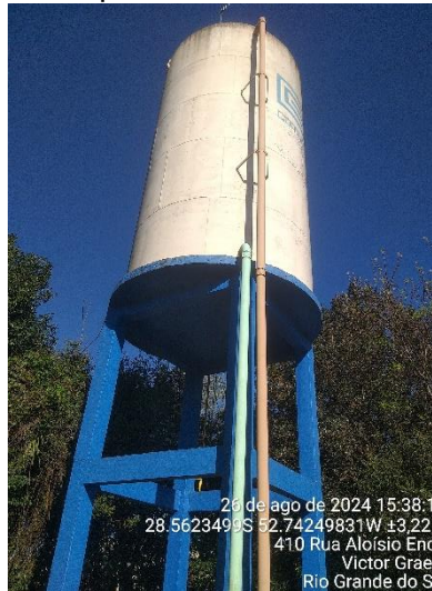
Figura 8 - Reservatório R2 Capacidade: 50 m³ - Metálico
