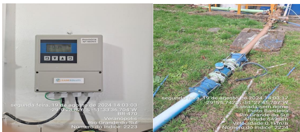
Figura 02: Macromedidor de entrada de água bruta na ETA para tratamento.
