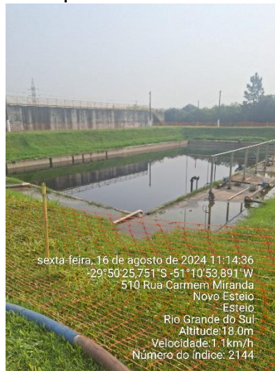
Figura 3 – Imagens do taque de lixiviado da ETE Esteio - Sapucaia do Sul.
