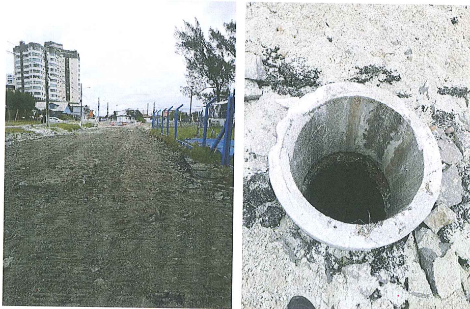
Figura 2 - Registros fotográficos do trecho fiscalizado em 17/02/23.
