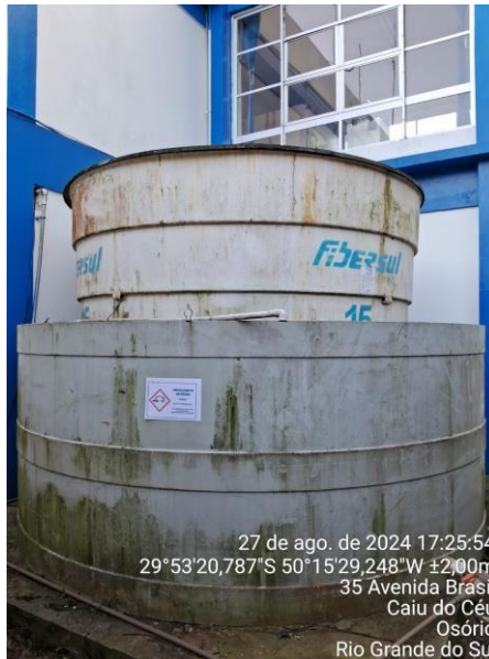
Tanque de Hipoclorito ETA- Osório
