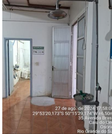
Chuveiro de emergência - ETA- Osório
