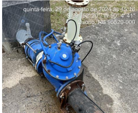
Tubulação Reservatório R-1- ETA II
