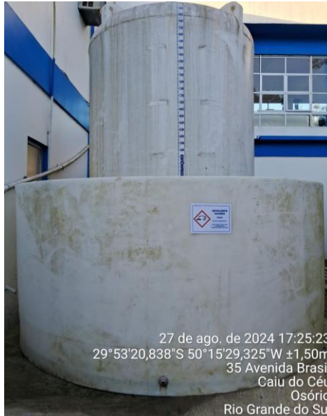
Tanque de Hipoclorito ETA- Osório
