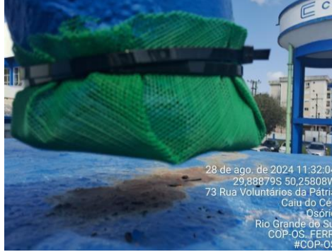
Tubulação Reservatório semi-enterrado ETA- Osório
