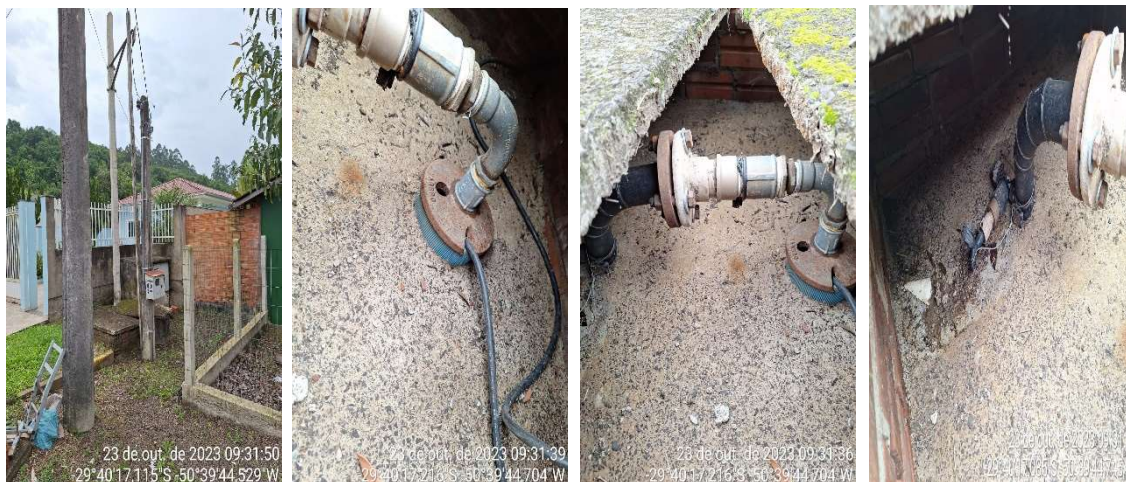
Figura 20: Poço 19 – Fazenda Passos
