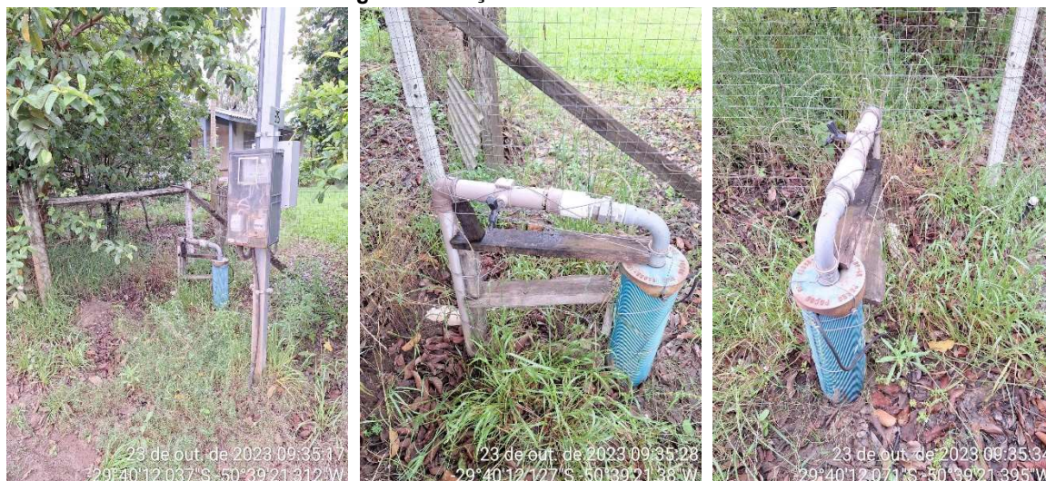
Figura 21: Poço 20 – Fazenda Passos
