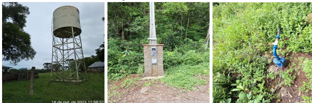
Figura 9: Poço 8 – Fazenda Fleck
