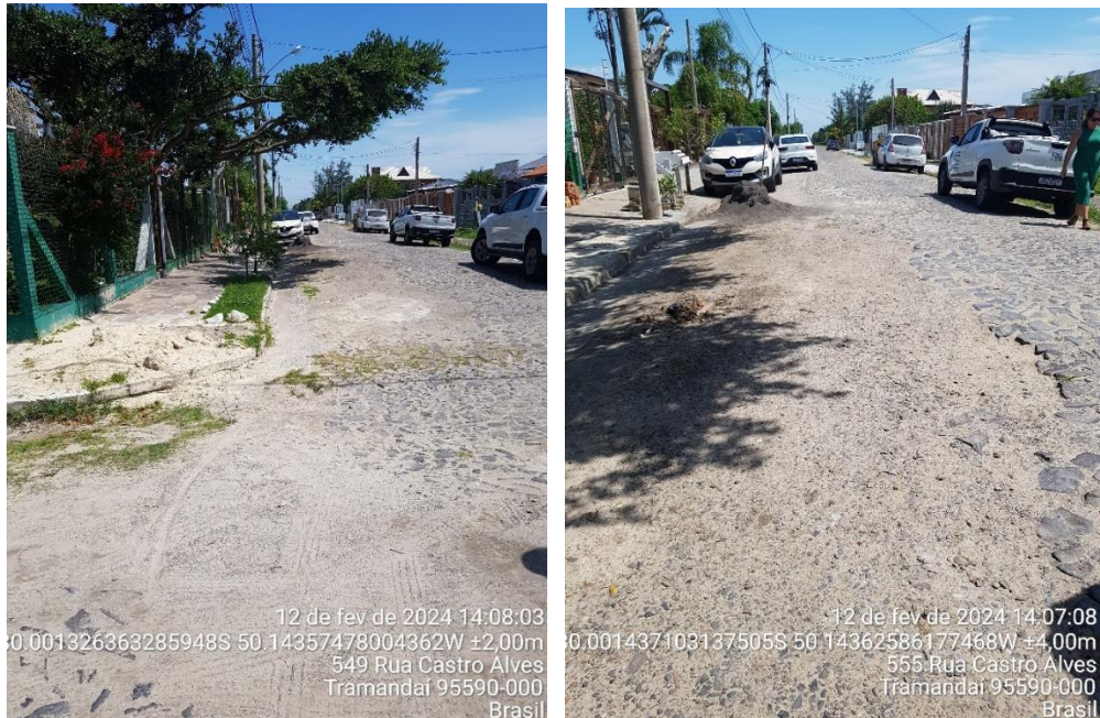
Figura 6 – Registros fotográficos do ponto 2, com deformidades na pavimentação.
