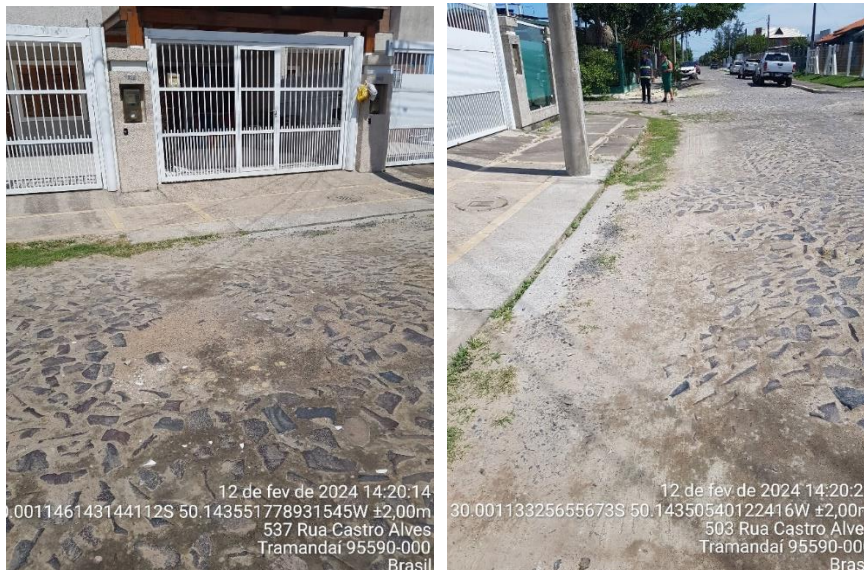
Figura 3 – Registros fotográficos do ponto 1, em frente à residência, com ausência das pedras irregulares.
