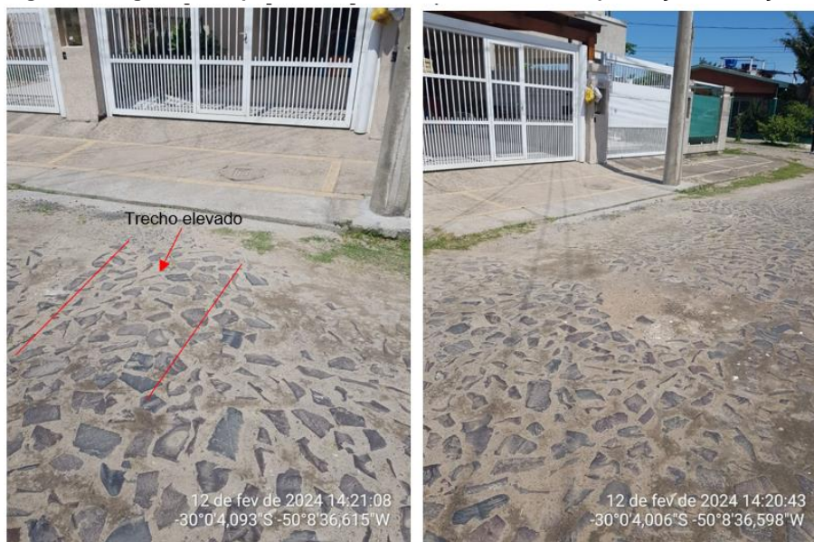
Figura 4 – Registros fotográficos do ponto 1, em frente à residência, com a presença de elevação no pavimento.
