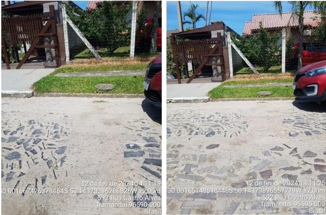
Figura 5 – Irregularidades na pavimentação em demais pontos da via.
