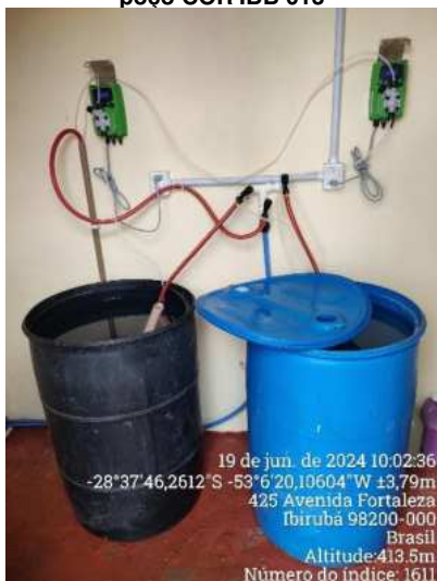
Figura 3 – Interior da casa de química simplificada do poço COR IBB 013
