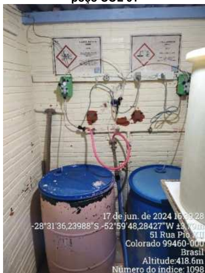
Figura 3 – Interior da casa de química simplificada do poço COL 01
