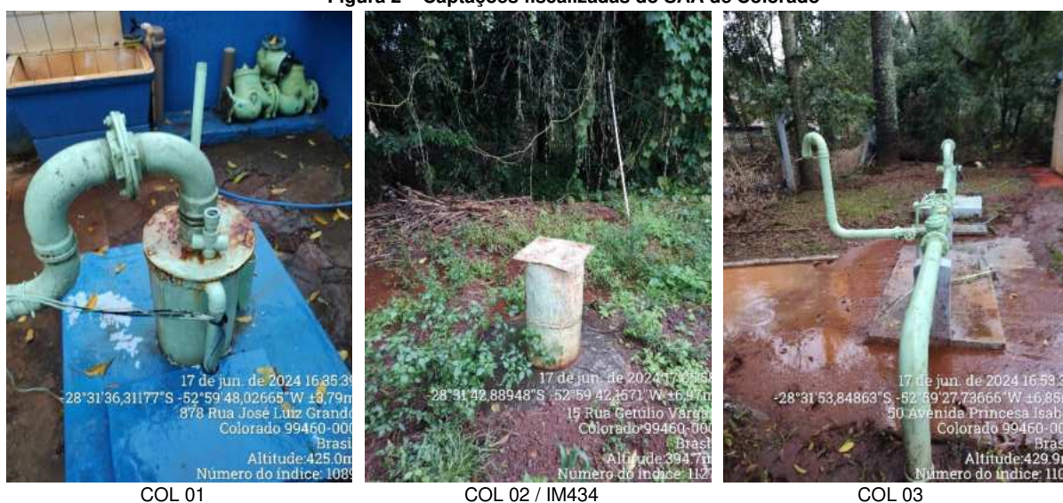
Figura 2 – Captações fiscalizadas do SAA de Colorado
