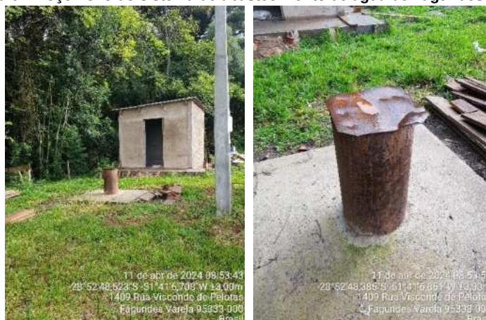
Figura 6 – Poço novo do sistema de abastecimento de água de Fagundes Varela.
