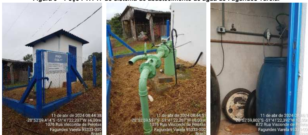
Figura 5 – Poço FVA-17 do sistema de abastecimento de água de Fagundes Varela.
