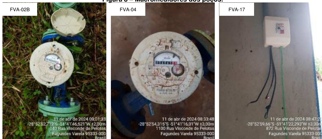
Figura 8 – Macromedidores dos poços.
