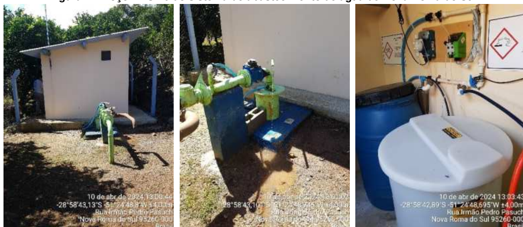
Figura 4 – Poço NRS-10 do sistema de abastecimento de água de Nova Roma do Sul.
