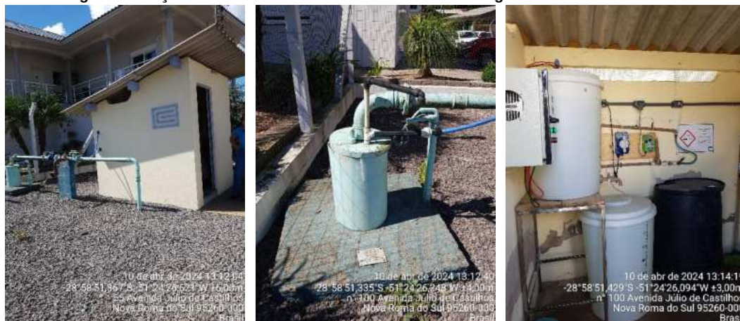
Figura 1 – Poço NRS-06A do sistema de abastecimento de água de Nova Roma do Sul.
