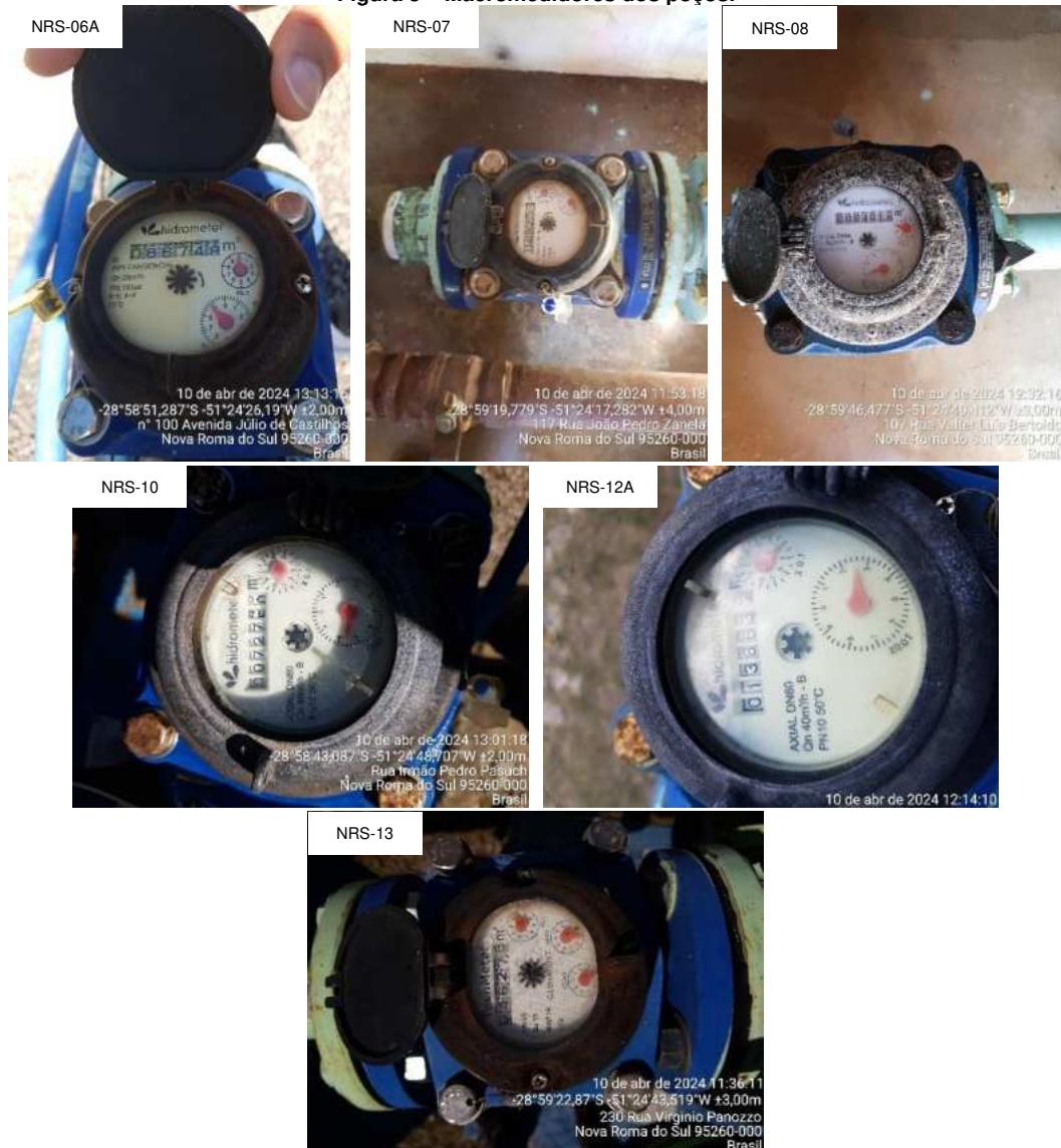
Figura 8 – Macromedidores dos poços.
