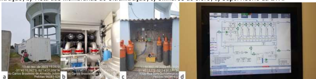
Figura 21: Registros fotográficos das estruturas da ETA: a) Vista do contentor onde está instalado o sistema de ultrafiltração; b) Vista das Membranas de Ultrafiltração; c) Cilindros de cloro; d) Supervisório da ETA.
