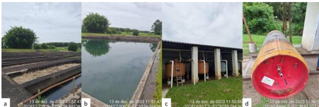
Figura 18: Registros fotográficos das estruturas da ETA: a) Floculador; b) Decantador; c) Filtros Rápidos; d) Cilindro de cloro.
