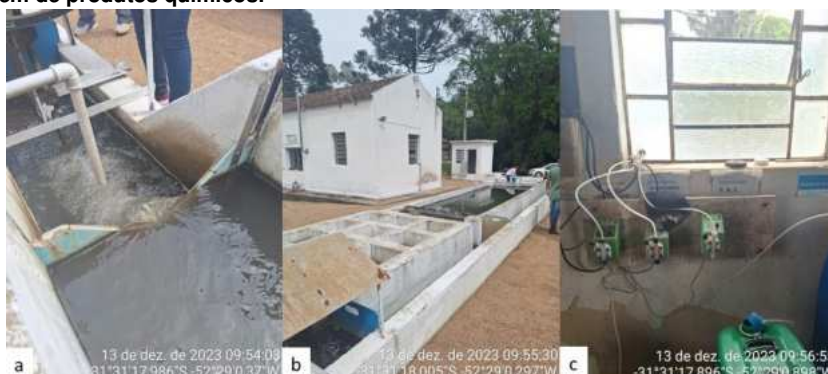
Figura 15: Registros fotográficos das estruturas da ETA: a) Chegada de Água Bruta; b) Floculador e Decantador; c) Sistema de dosagem de produtos químicos.
