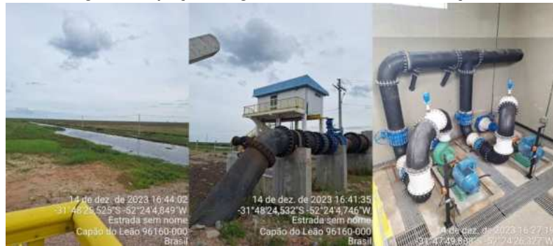
Figura 5: Captação de água bruta do Sistema São Gonçalo.
