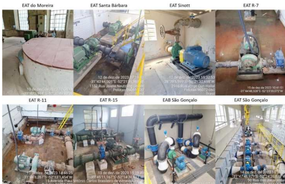
Figura 27: Estações elevatórias de água.
