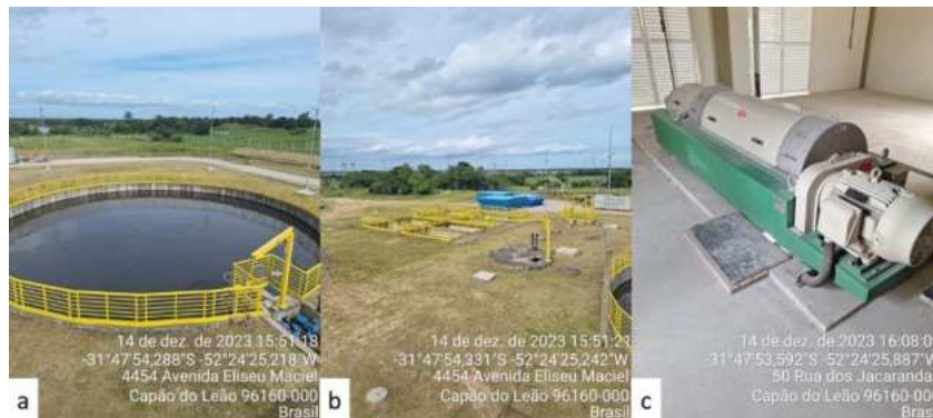
Figura 25: Registros fotográficos das unidades do sistema de tratamento de lodo: a) Adensador; b) Equalizador; c) Centrífuga.
