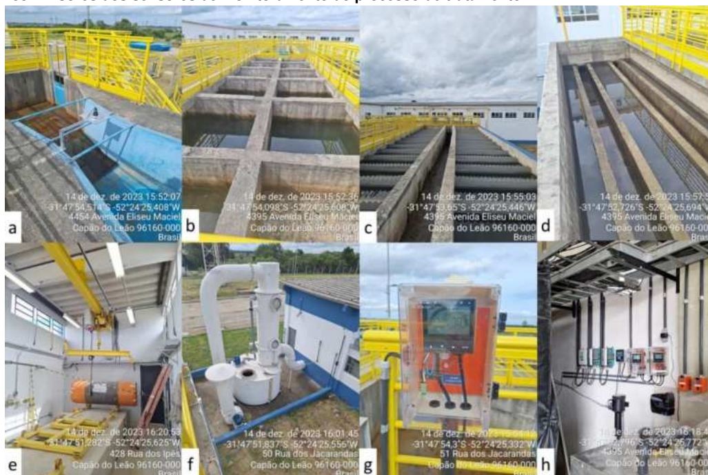
Figura 24: Registros fotográficos das estruturas da ETA: a) Calha Parshall; b) Floculador; c) Decantadores; d) Filtros; e) Cilindro de Cloro Gasoso; d) Lavador de Gases; e) Visor de um dos sensores posicionados ao longo do bloco hidráulico; f) Central com visores dos sensores de monitoramento do processo de tratamento.
