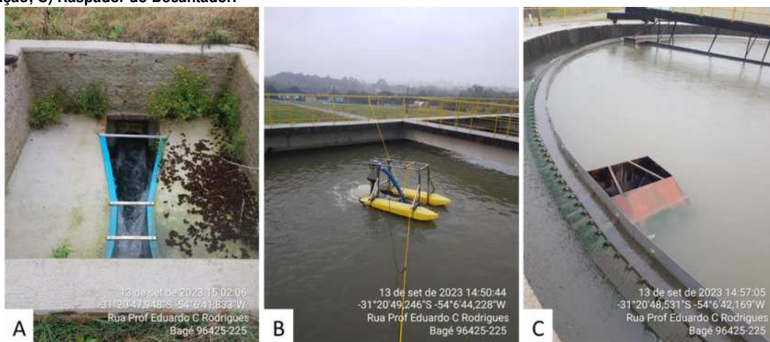
Figura 1: Melhorias na ETE Central: A) Calha Parshall no Tratamento de Lodo; B) Aeradores Superficiais no Tanque de Aeração; C) Raspador do Decantador.
