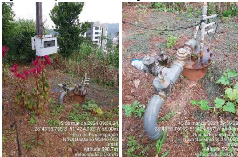
Figura 10 – Estação de bombeamento de água tratada 2 em Nova Bassano.
