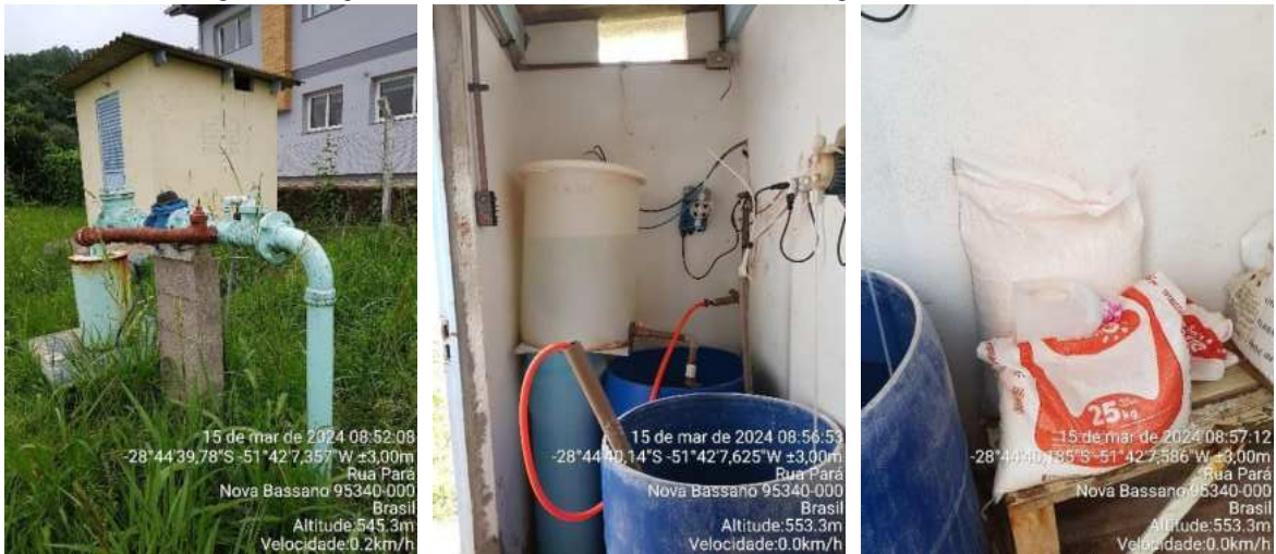
Figura 5 – Poço NBA13 do sistema de abastecimento de água de Nova Bassano.
