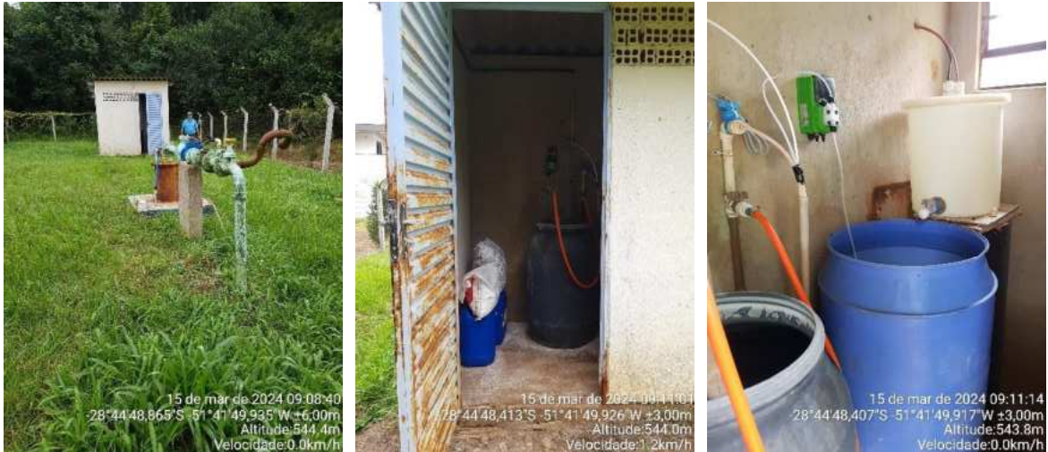
Figura 4 – Poço NBA08 do sistema de abastecimento de água de Nova Bassano.
