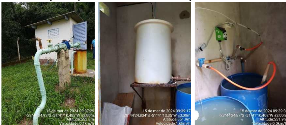
Figura 6 – Poço NBA16 do sistema de abastecimento de água de Nova Bassano.
