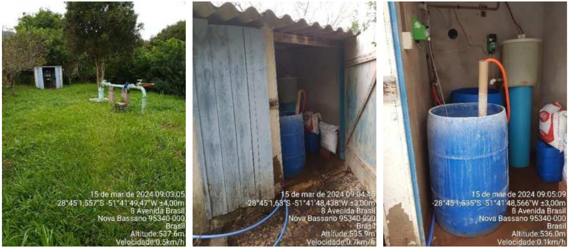
Figura 3 – Poço NBA07 do sistema de abastecimento de água de Nova Bassano.
