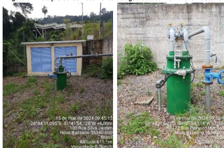
Figura 9 – Estação de bombeamento de água tratada 1 em Nova Bassano.
