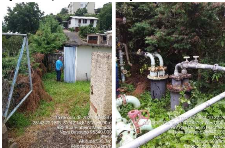
Figura 11 – Estação de bombeamento de água tratada 3 em Nova Bassano.
