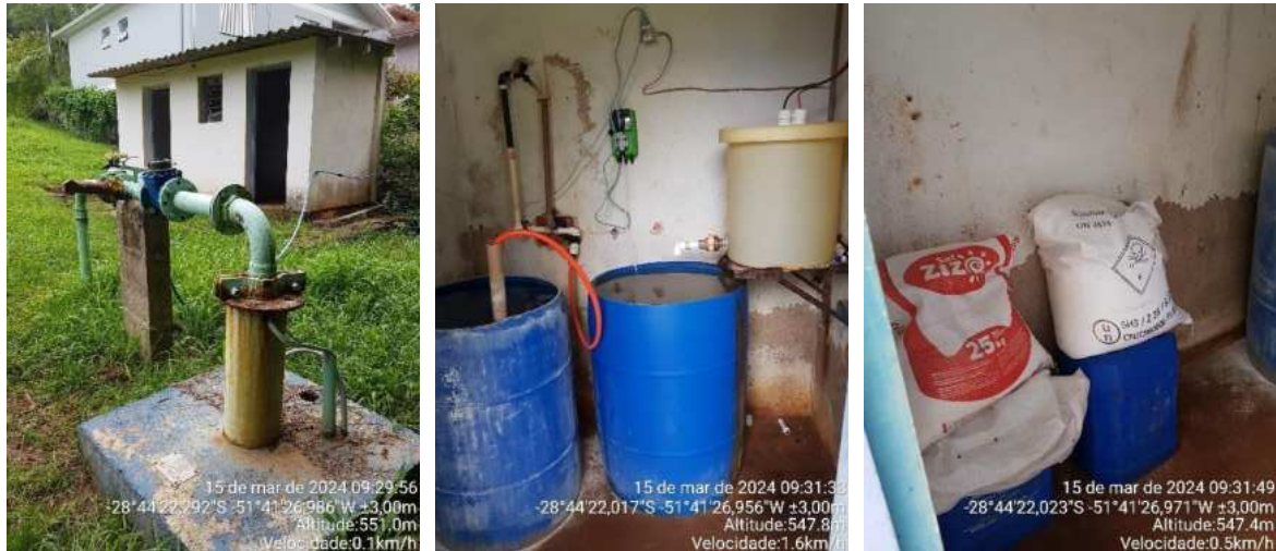
Figura 2 – Poço NBA06A do sistema de abastecimento de água de Nova Bassano.
