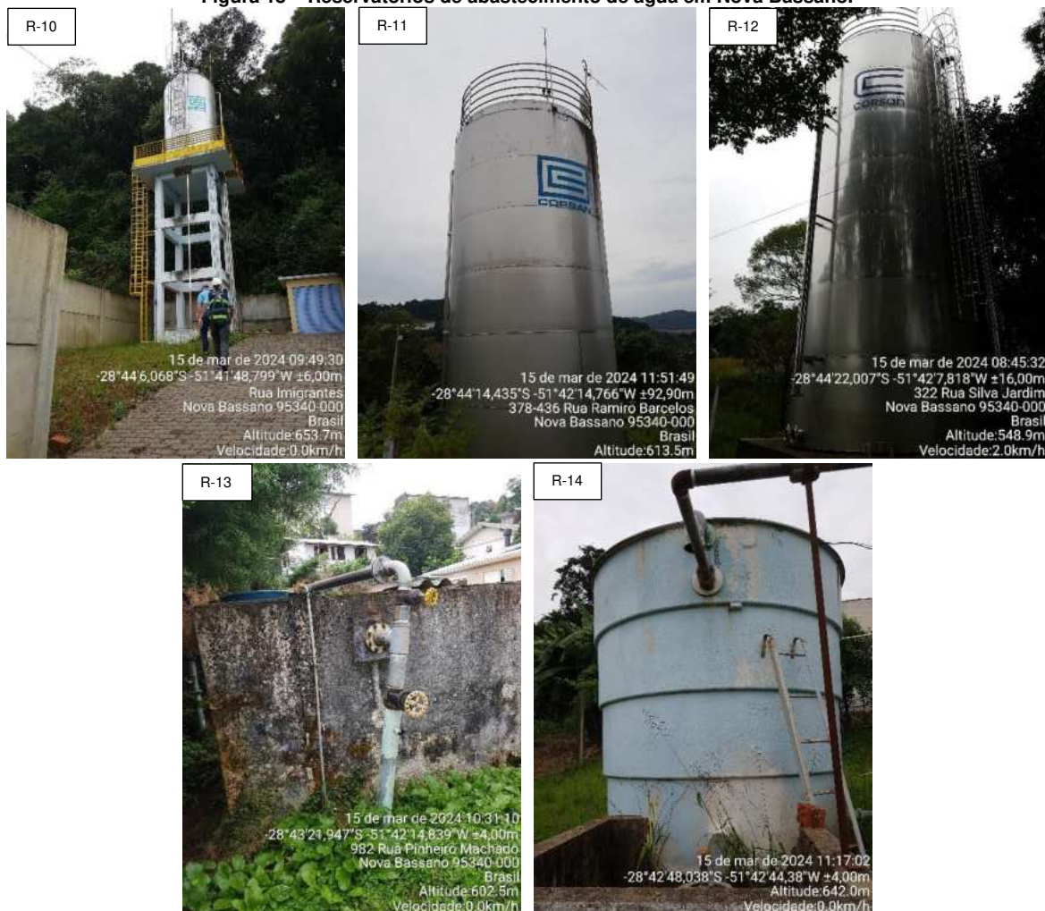
Figura 18 – Reservatórios de abastecimento de água em Nova Bassano.
