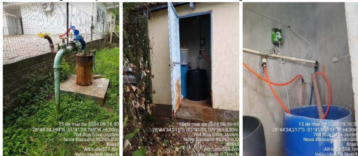
Figura 7 – Poço NBA20B do sistema de abastecimento de água de Nova Bassano.
