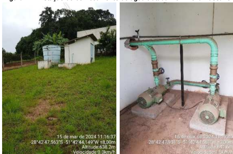
Figura 12 – Estação de bombeamento de água tratada 4 em Nova Bassano.
