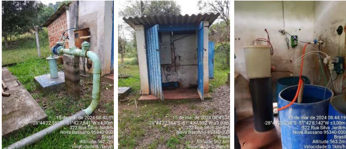
Figura 1 – Poço NBA05 do sistema de abastecimento de água de Nova Bassano.
