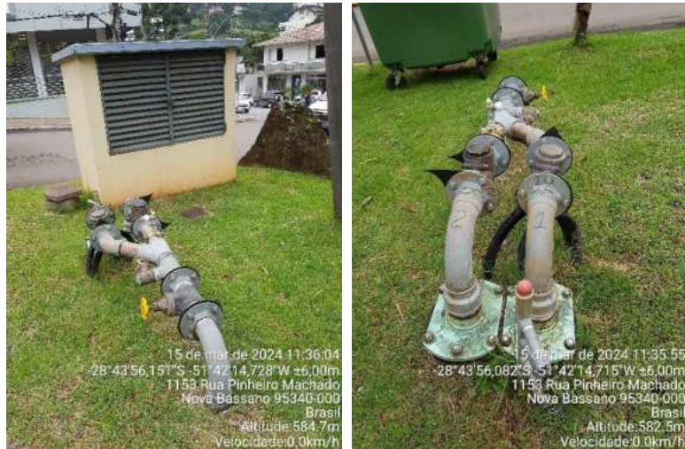
Figura 13 – Estação de bombeamento de água tratada 5 em Nova Bassano.
