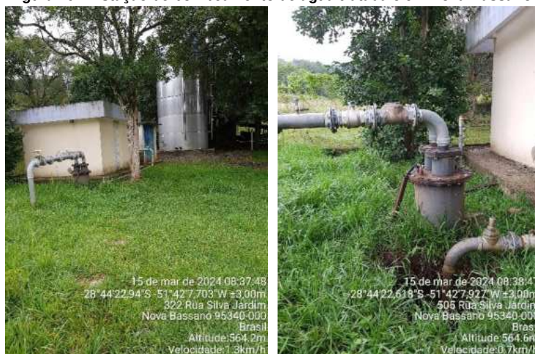
Figura 16 – Estação de bombeamento de água tratada 8 em Nova Bassano.
