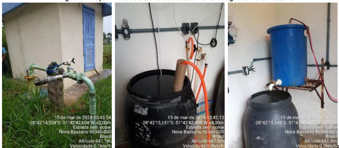
Figura 8 – Poço NBA26 do sistema de abastecimento de água de Nova Bassano.
