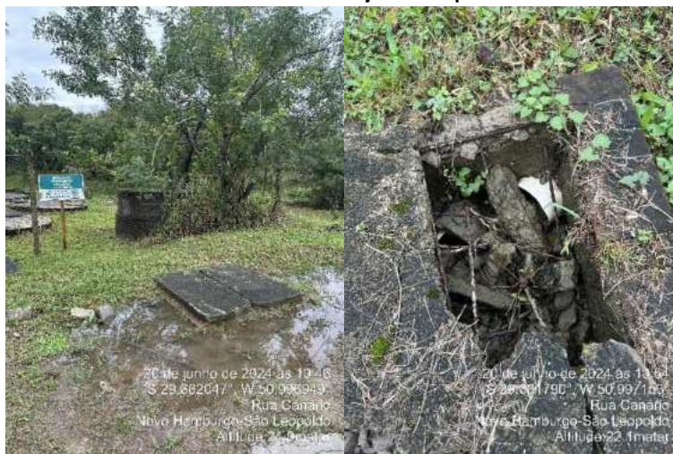
Figura 4: Não conformidades encontradas nos TSC já sob responsabilidade da Corsan – Sapiranga
