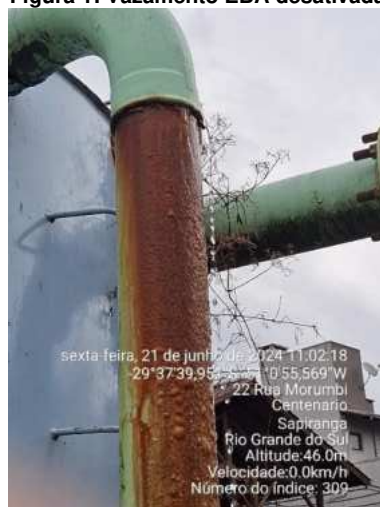
Figura 1: Vazamento EBA desativada
