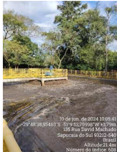
Figura 6 – Imagem de um dos taques aerados durante o funcionamento do aerador.
