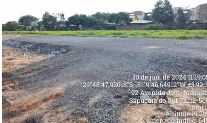
Figura 15 – ETA emergencial COHAB – não instalada.
