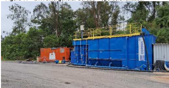
Figura 11 – ETA emergencial Gerdau – operacionalizada.
