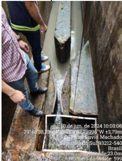
Figura 5 – Desarenador, gradeamento tipo cesto e calha parshal
