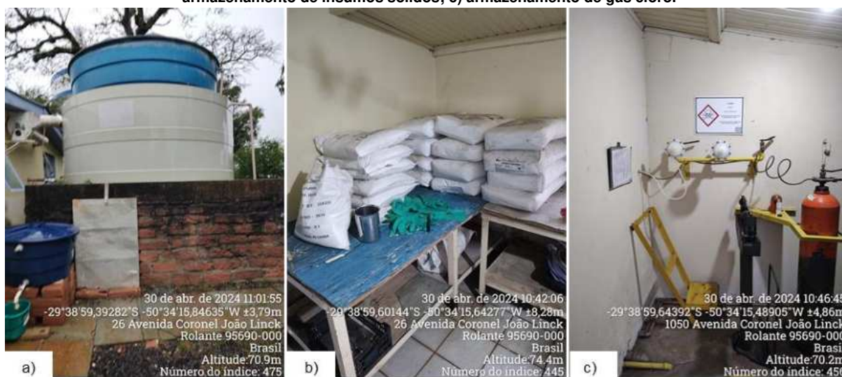
Figura 6 – Armazenamentos de insumos da ETA: a) armazenamento de insumo líquido sem identificação; b) armazenamento de insumos sólidos; c) armazenamento de gás cloro.
