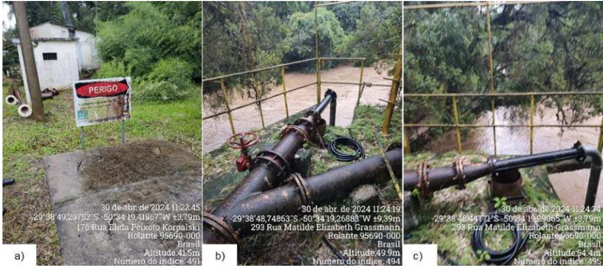
Figura 2 – Estrutura da captação de água bruta em Rolante: a) vista para o ponto de realização de limpeza interna da adutora, casa de força, e aos fundos casa de painéis elétricos dos conjuntos motobomba; b) plataforma de tomada de água onde localizam-se os conjuntos motobomba.
