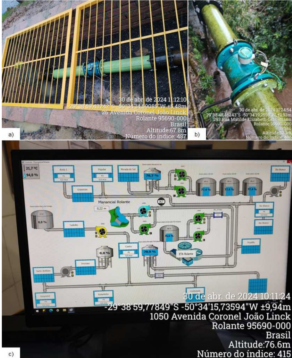
Figura 12 - Macromedidores: a) Macromedidor da EBAT 02; b) Macromedidor da captação; c) Supervisório.
