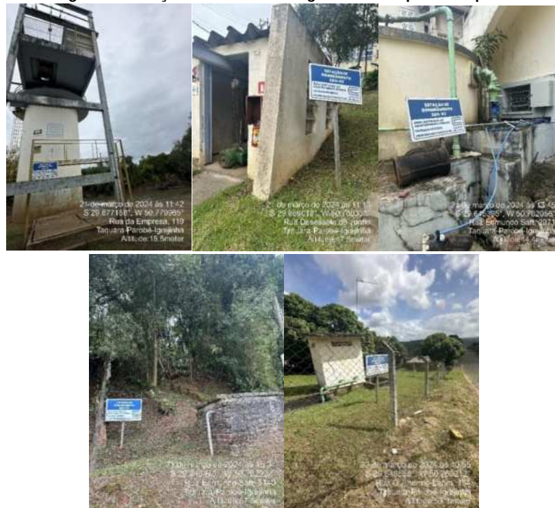
Figura 12: Estações elevatórias de água do município de Taquara.
