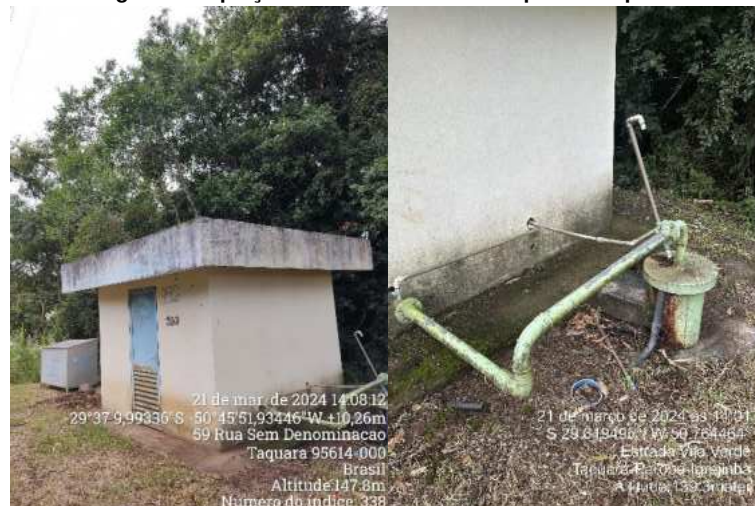
Figura 3: Captação subterrânea no município de Taquara.
