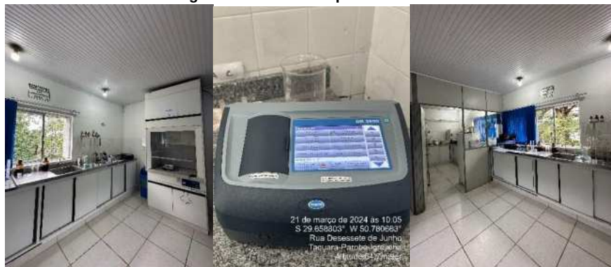
Figura 6: Laboratório químico da ETA.
