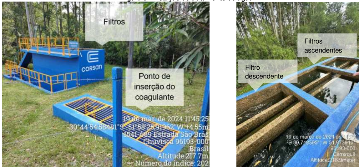
Figura 5 – Estação de tratamento de água
