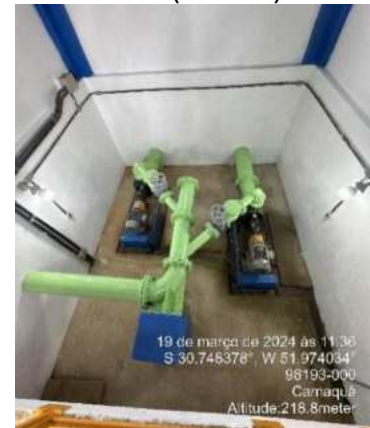
Figura 10 – Estação de bombeamento para lavagem dos filtros (EB filtros)
