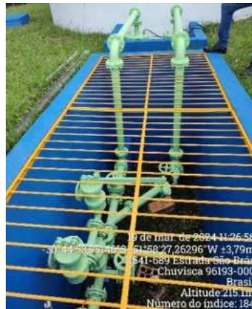
Figura 9 – Estação de bombeamento de água tratada (EBA 02)
