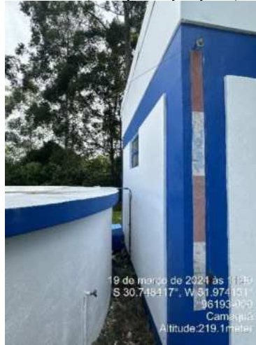
Figura 14 – Método de controle de nível no R01, composto por peso, corda e marcação na parede.
