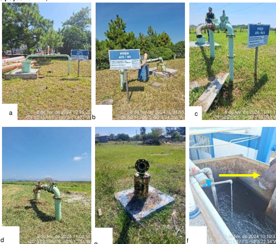
Figura 2: Identificação dos poços existentes que compõem o SAA de Xangri-Lá. a) Poço ATL 01; b) Poço ATL 02; c) Poço ATL 03; d) Poço ATL 04; e) Poço desativado junto aos reservatórios R-14 e R-14b; f) entrada da água bruta captada dos poços na ETA;
