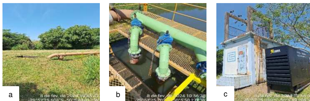
Figura 1: Identificação da área de captação e adução de água bruta superficial. a) adução subterrânea de água bruta para a ETA; b) estrutura de captação superficial reformada; c) gerador elétrico instalado.
