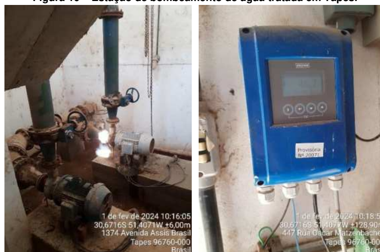
Figura 10 – Estação de bombeamento de água tratada em Tapes.
