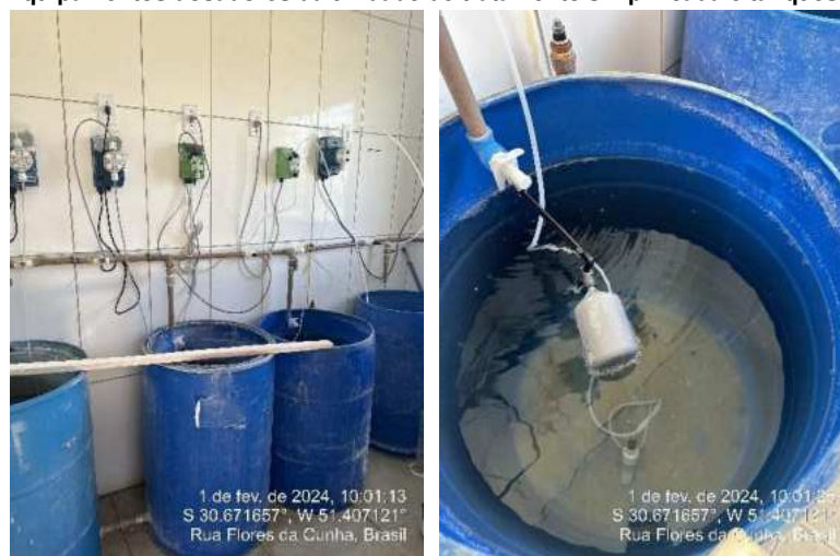
Figura 7 – Equipamentos dosadores da unidade de tratamento simplificada e tanques de solução.
