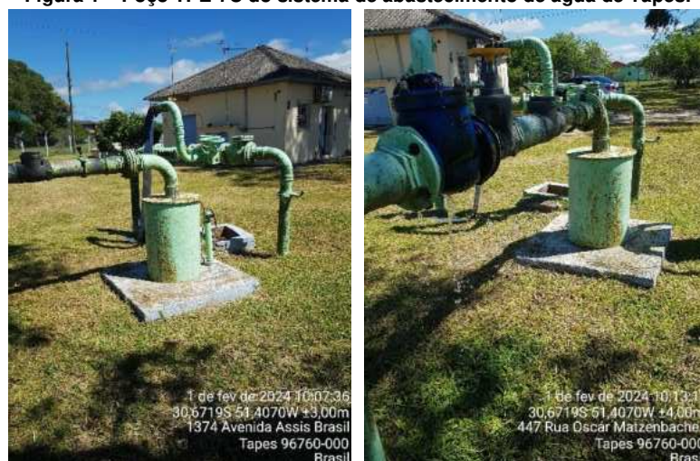
Figura 1 – Poço TPE-7C do sistema de abastecimento de água de Tapes.
