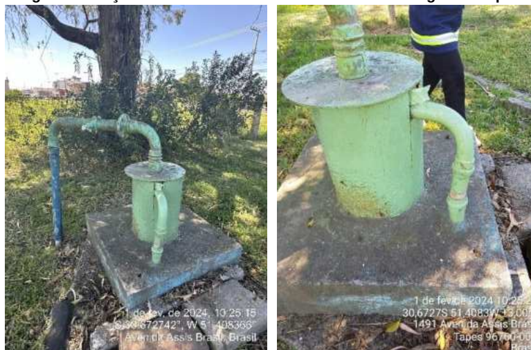
Figura 6 – Poço TPE-14 do sistema de abastecimento de água de Tapes.
