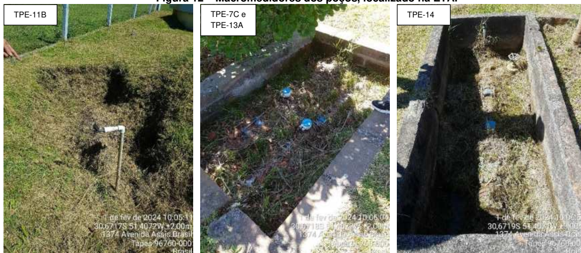
Figura 12 – Macromedidores dos poços, localizado na ETA.
