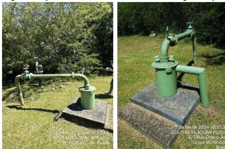
Figura 5 – Poço TPE-13A do sistema de abastecimento de água de Tapes.
