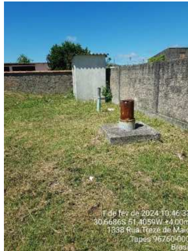
Figura 3 – Poço TPE-9B do sistema de abastecimento de água de Tapes.
