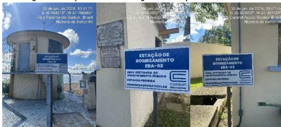
Figura 11: Estações elevatórias de água do município de Barra do Ribeiro.
