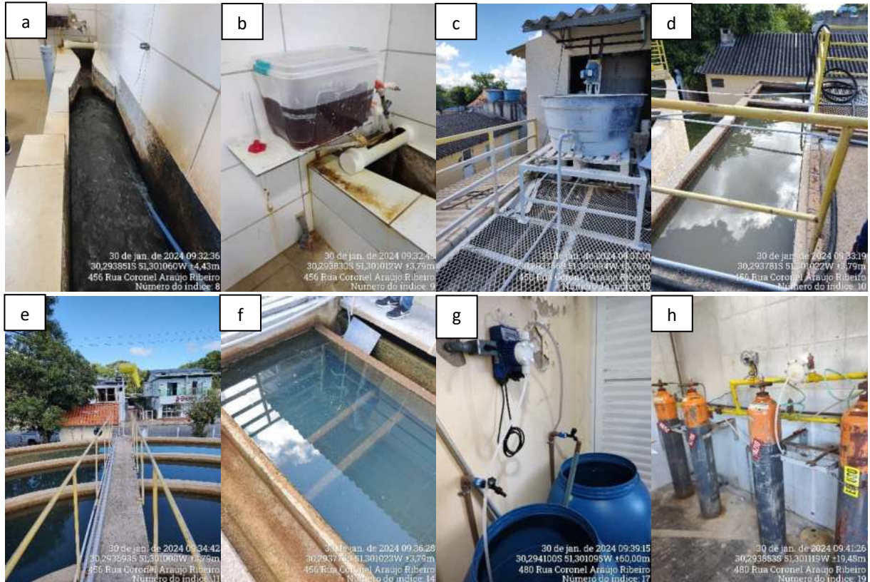
Figura 6: Registros fotográficos das estruturas da ETA: a: entrada água bruta – Calha Parshal; b: local de dosagem de coagulante; c: local de dosagem cal; d: zona de mistura produtos químicos; e: decantador; f: filtro; g: local de dosagem de flúor; h: cilindros de cloro.
