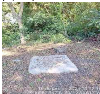
Figura 2 – Relatório fotográfico do poço tamponado ETA 02 localizado na área da ETA Convencional.
