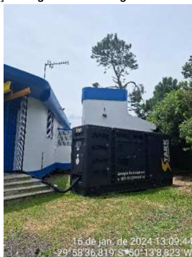
Figura 1 – Identificação do gerador de energia à diesel disponível na unidade.
