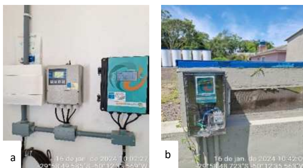
Figura 4 – Macromedidores instalados na ETA. a) à esquerda: macromedidor instalado adutora 400 mm; macromedidor instalado adutora 500 mm; b) macromedidor da entrada de água da ETA compacta.
