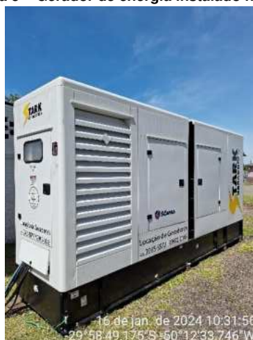
Figura 5 – Gerador de energia instalado na ETA.
