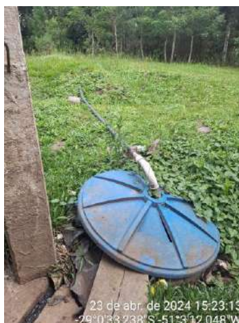
Figura 05: Drenagem de chorume da Unidade de Transbordo de São Marcos.
