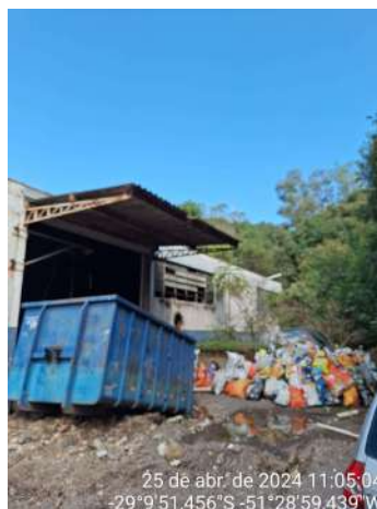
Figura 20: Caçamba coletora de rejeitos para transporte até destinação final na Cooperativa Pinheiros.
