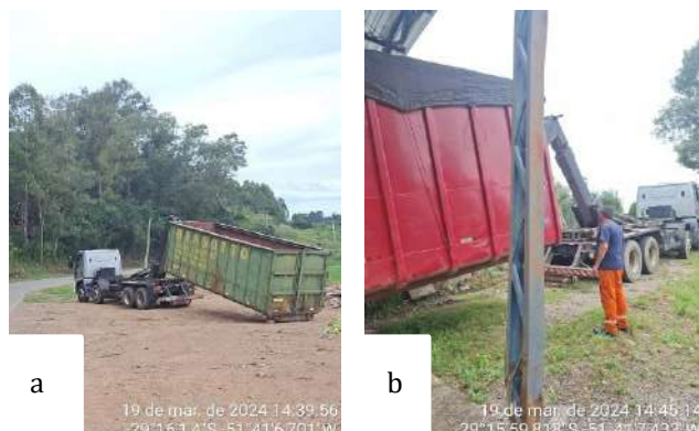
Figura 02: Transporte de rejeitos da Estação de Transbordo para sede da empresa em Coronel Pilar/RS. a) Veículo realizando a descarga do contentor vazio; b) Mesmo veículo realizando a troca dos contentores.
