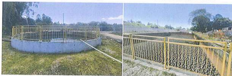
Figura 11: Registros fotográficos do tratamento do lodo da ETA.
