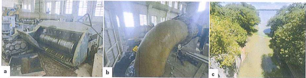
Figura 6: Captação do município de Charqueadas: a) Peneira rotativa; b) Sistema de bombeamento; c) Manancial hídrico.
