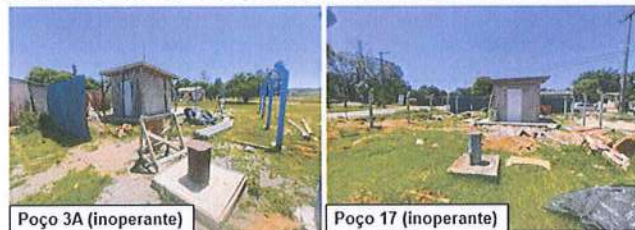
Figura 7: Poços vistoriados no município de São Francisco de Assis que ainda não entraram em operação.
