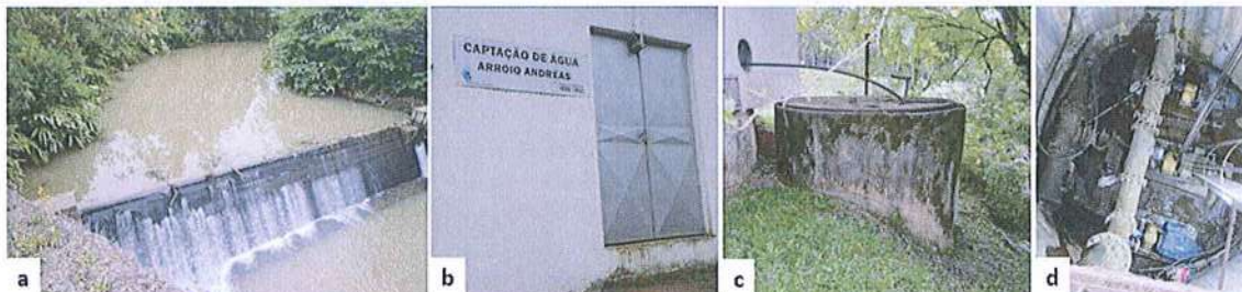
Figura 6: Captação Arroio Andréas: a) Barramento; b) Casa de Bombas; c) Poço de Sucção; d) Conjuntos motobomba
