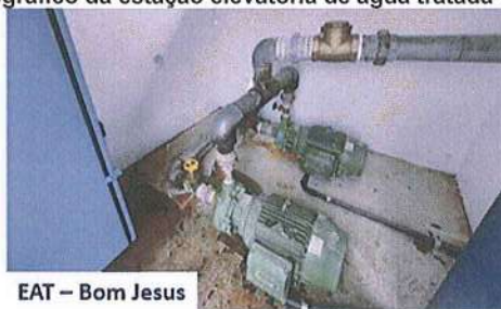
Figura 18: Registro fotográfico da estação elevatória de água tratada fiscalizada em Vera Cruz.
