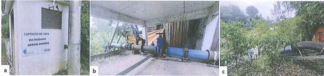
Figura 7: Captação Rio Pardinho: a) Identificação da captação; b) Registro de manobra; c) Ponto de captação onde está instalada a bomba submersa
