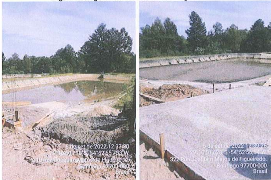
Figura 10: Registro do reservatório de lavagem de filtro
