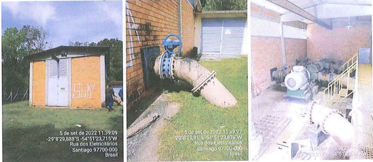
Figura 6: Registro fotográfico da elevatória de água bruta
