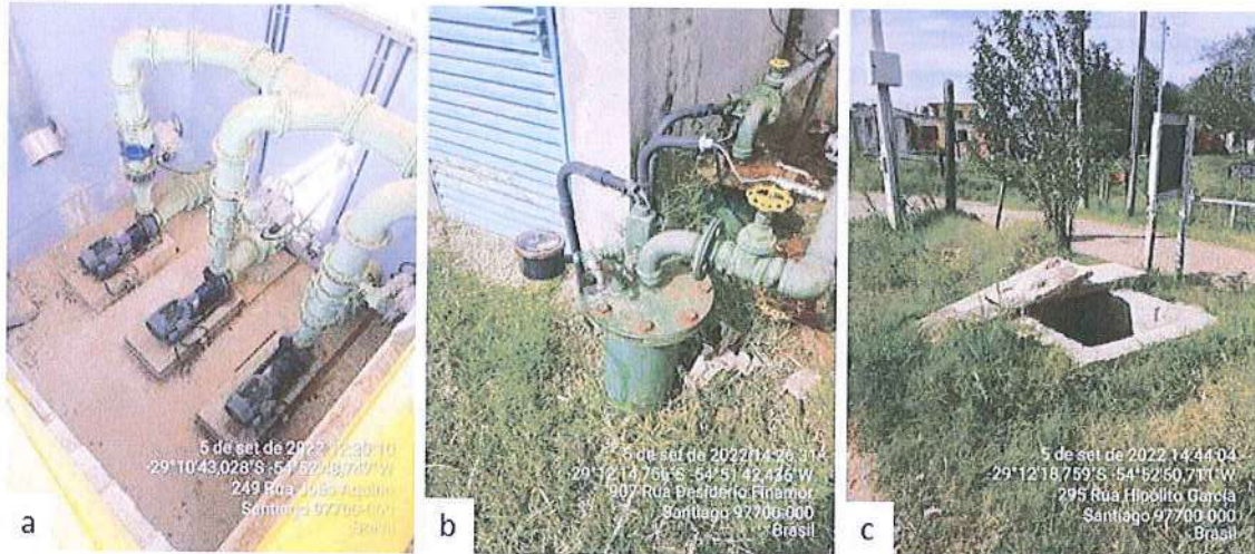
Figura 18: Registro fotográfico das elevatórias de água tratada: a) segundo recalque; b) booster Desidério; c) Booster da Bento.
