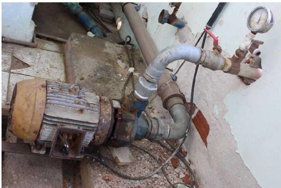
Figura 27 - Bomba poço de contribuição Stand
