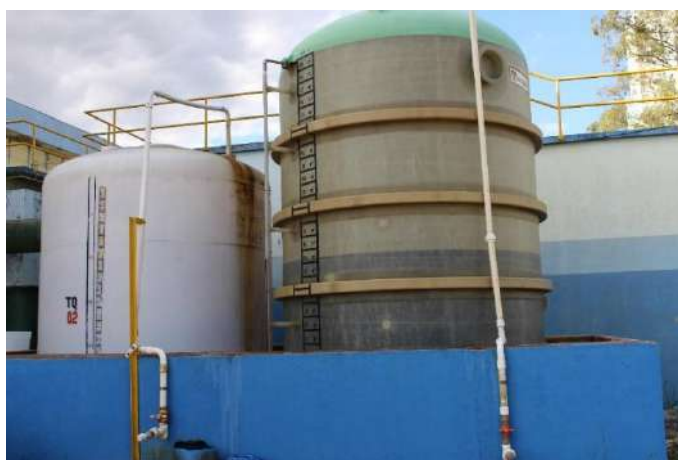
Figura 7 - Tanques de armazenamento de Sulfato
