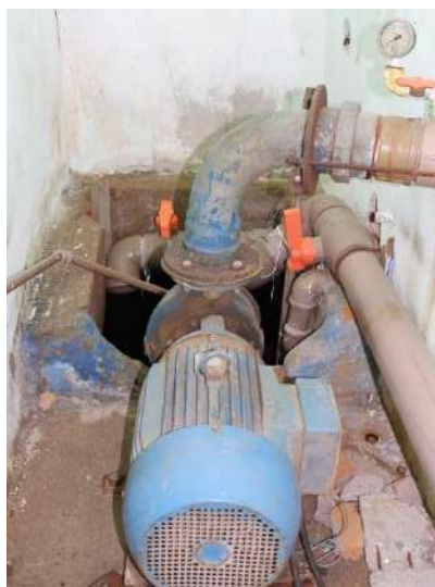
Figura 26 - Bomba reservatório apoiado Stand
