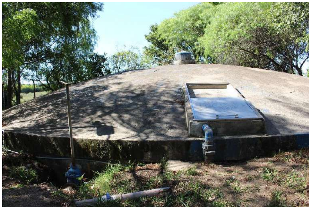
Figura 52 - Reservatório apoiado São Judas
