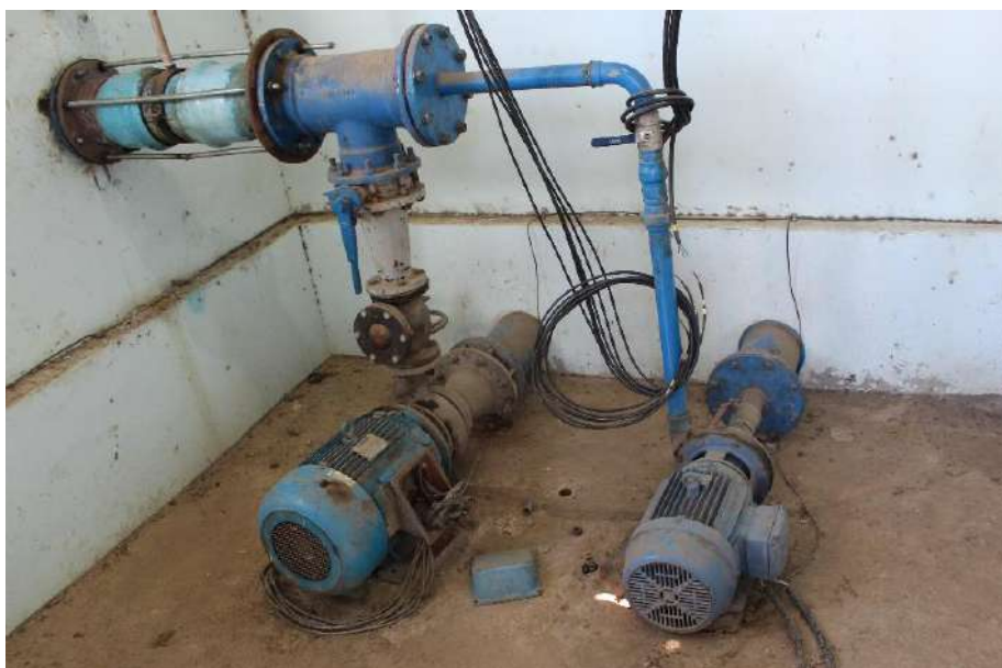
Figura 30 - Bombas reservatório apoiado São Martins
