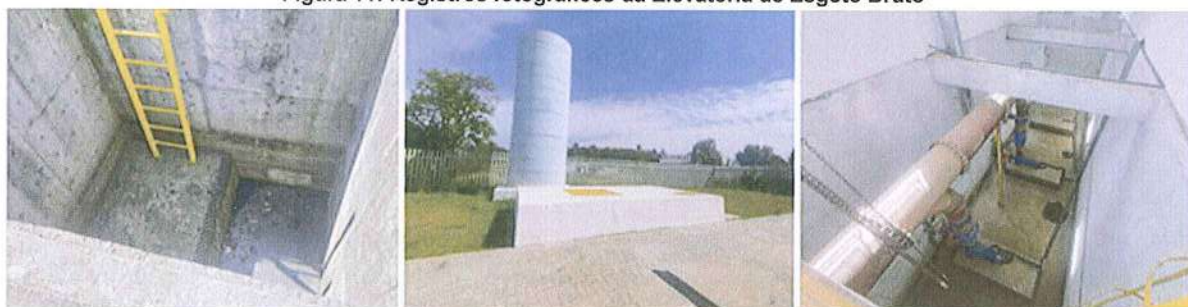
Figura 11: Registros fotográficos da Elevatória de Esgoto Bruto
