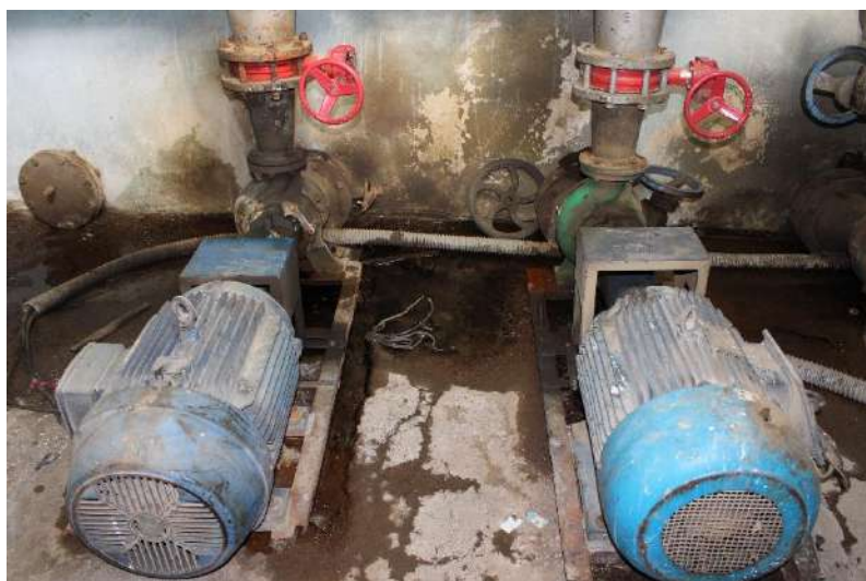
Figura 23 - Bombas de distribuição zona norte
