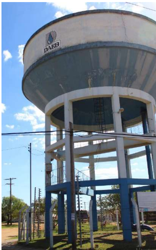
Figura 48 – Reservatório elevado Morro Belém
