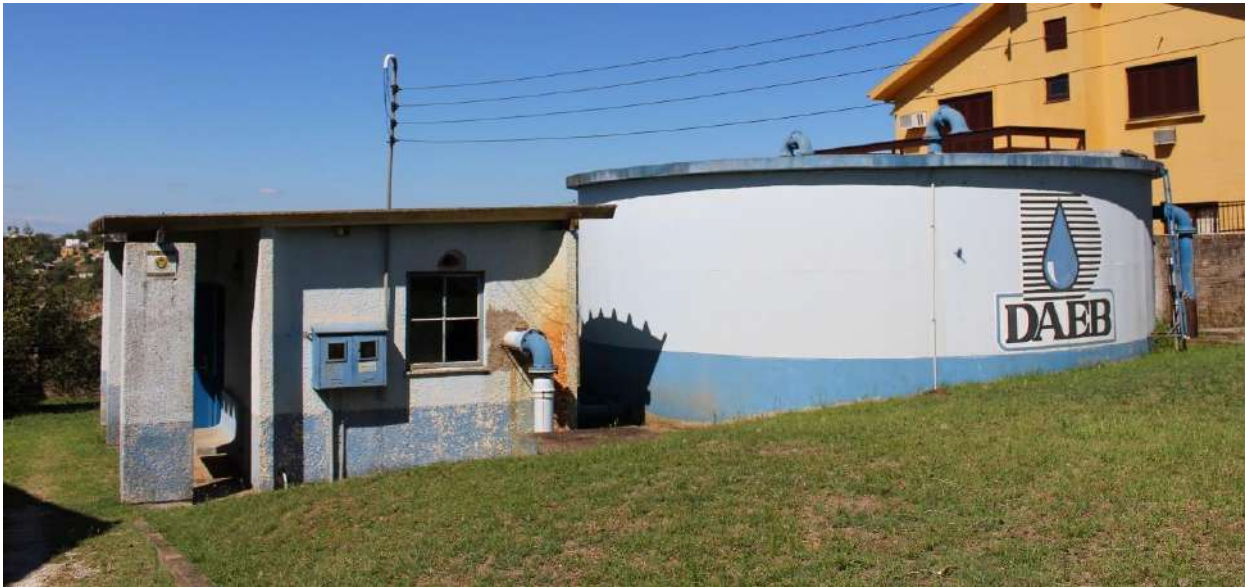
Figura 42 - Reservatório apoiado Laranjeiras
