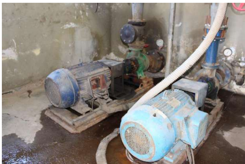
Figura 38 - Bombas reservatório apoiado Vila Militar
