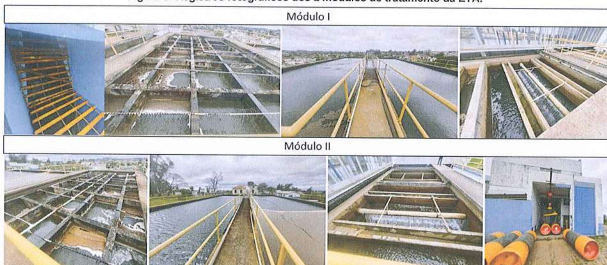
Figura 3: Registros fotográficos dos 2 módulos de tratamento da ETA.
