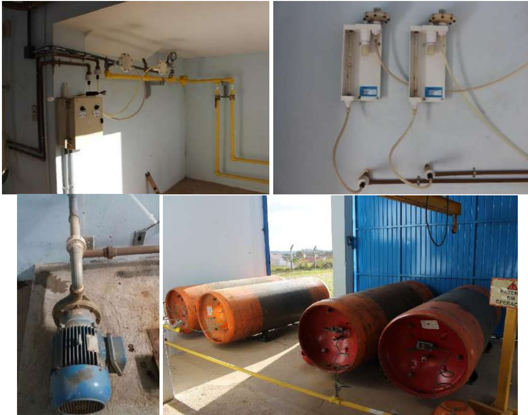
Figura 14 – Sistema de cloração
