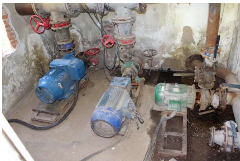
Figura 47 - Bombas reservatório apoiado Morro Belém
