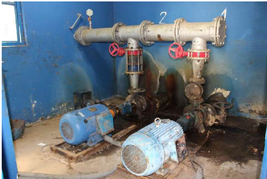
Figura 34 - Bombas reservatório apoiado São João
