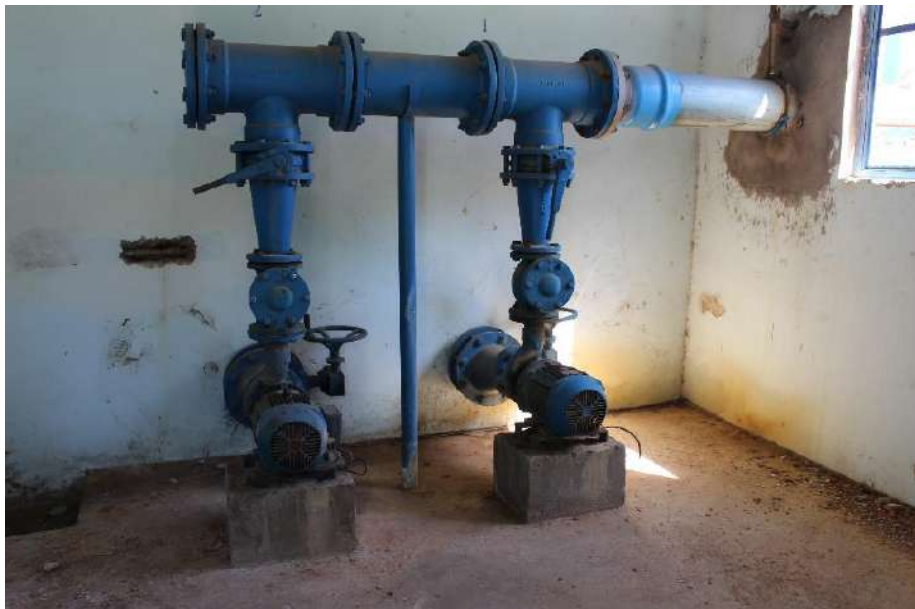
Figura 43 - Bombas reservatório apoiado Laranjeiras
