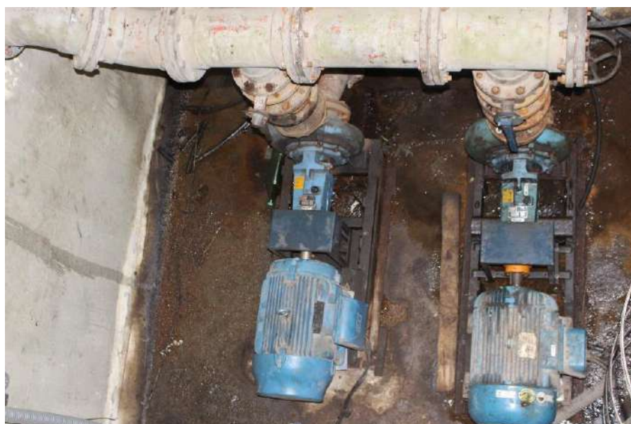
Figura 53 - Bombas reservatório apoiado São Judas
