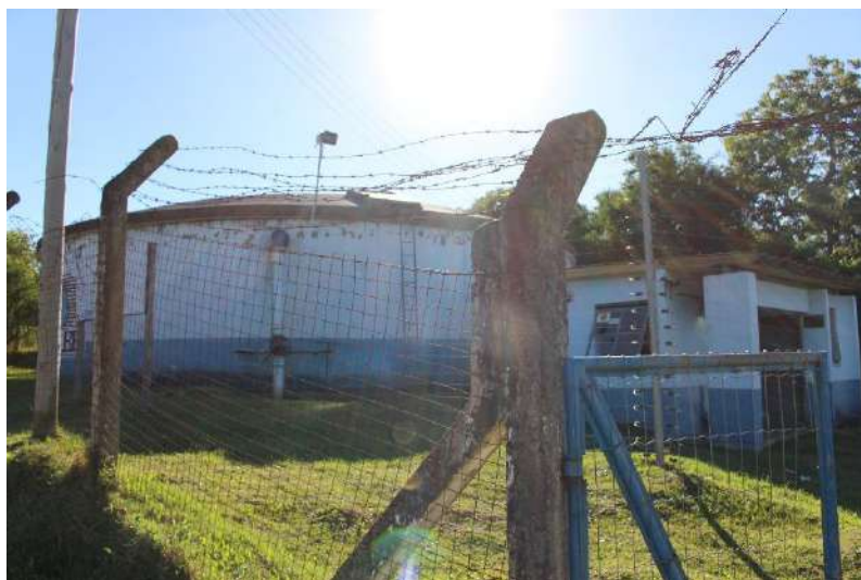
Figura 37 - Reservatório apoiado Vila Militar
