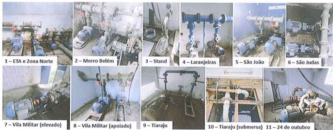
Figura 8: Registros fotográficos das elevatórias de água tratada.
