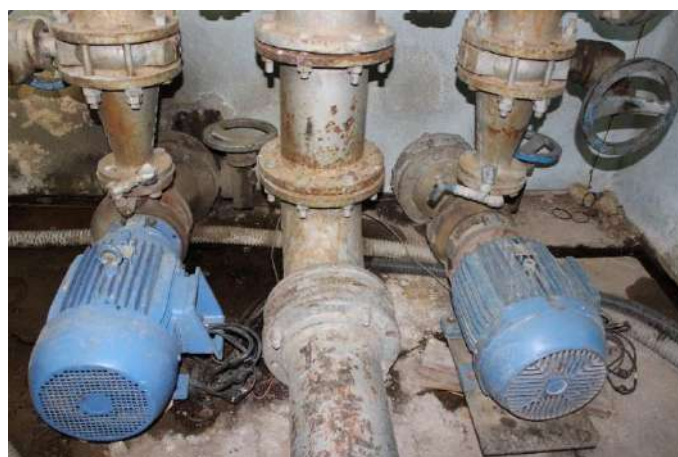
Figura 21 - Bombas de recalque ETA
