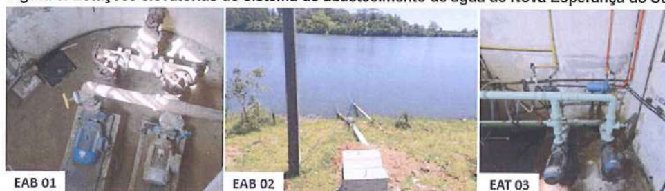
Figura 6: Estações elevatórias do sistema de abastecimento de água de Nova Esperança do Sul.
