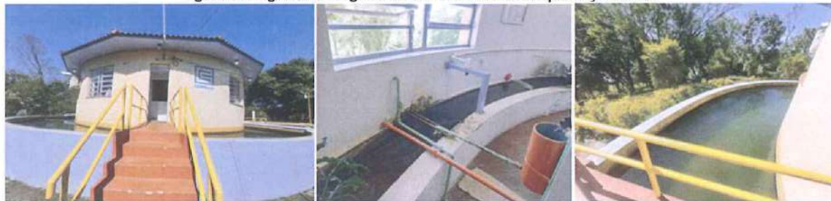
Figura 2: Registros fotográficos da ETA de Nova Esperança do Sul.
