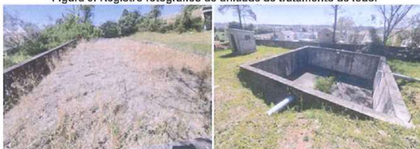
Figura 3: Registro fotográfico de unidade de tratamento de lodo.
