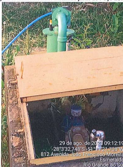
Figura 5: Macromedidor instalado junto ao Poço ESM 04.
