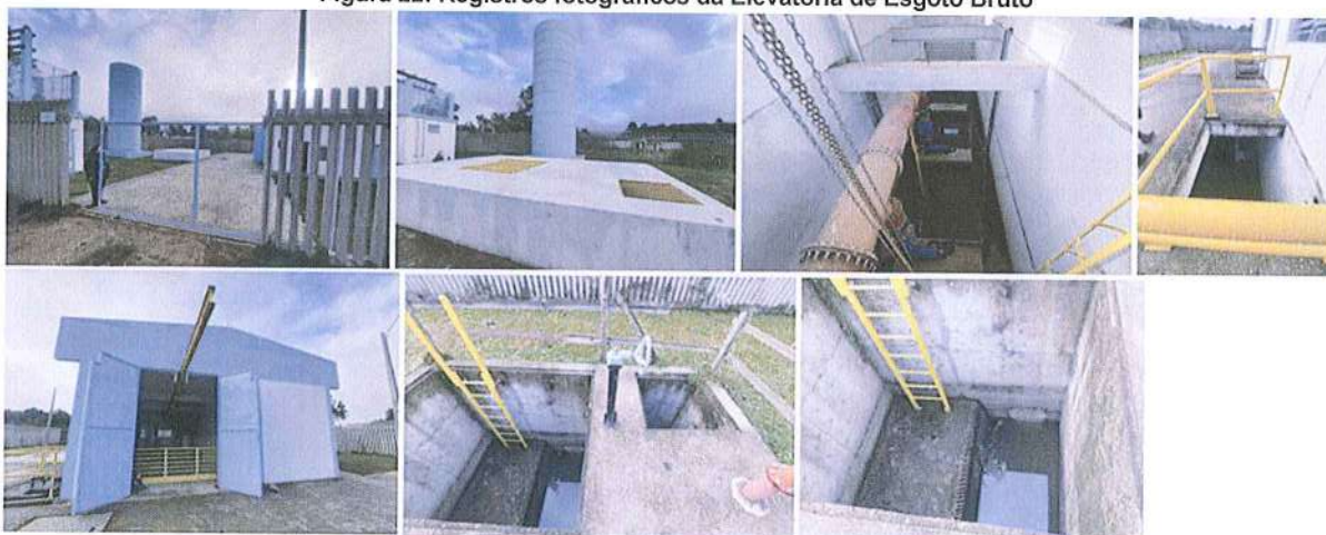
Figura 22: Registros fotográficos da Elevatória de Esgoto Bruto
