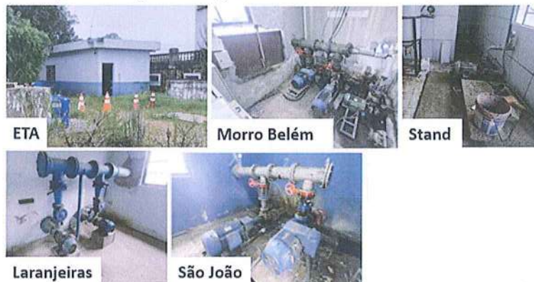
Figura 18: Registros fotográficos das elevatórias de água tratada.
