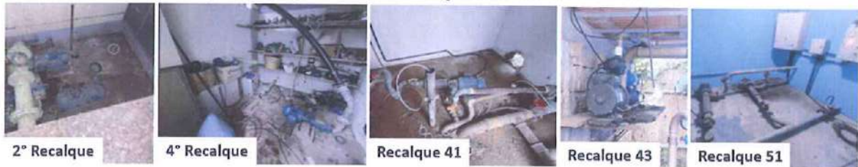
Figura 4: Estações elevatórias de água tratada fiscalizadas em Ivoti
