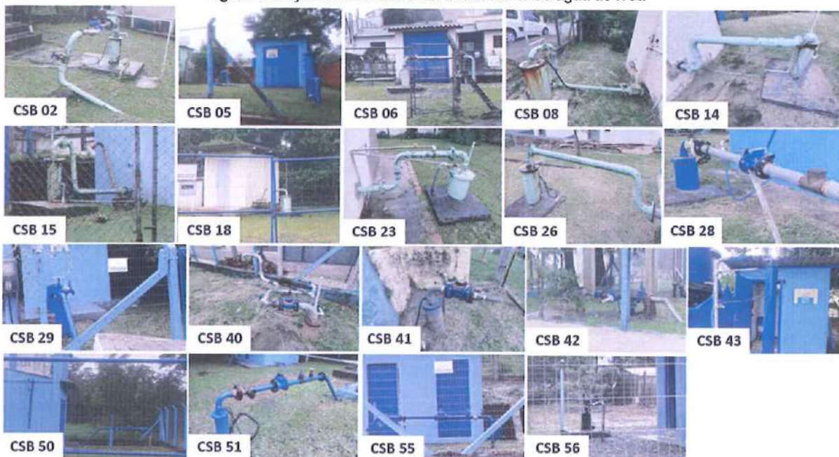
Figura 1: Poços do sistema de abastecimento de água de Ivoti
