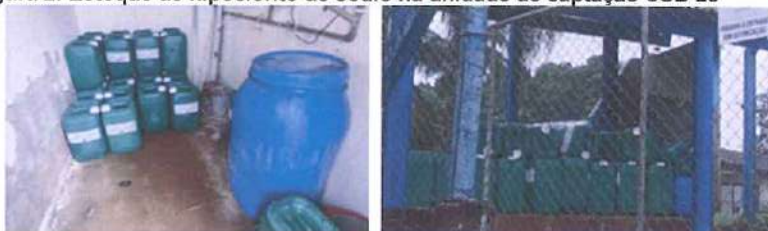
Figura 2: Estoque de hipoclorito de sódio na unidade de captação CSB 23
