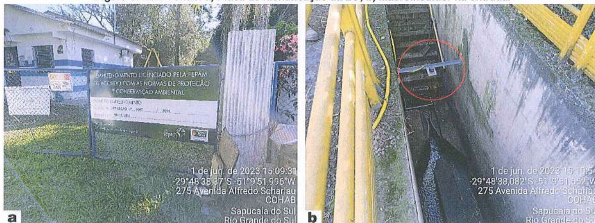
Figura 5: ETE Cohab: a) Placa de identificação da LO; b) Macromedidor na entrada.
