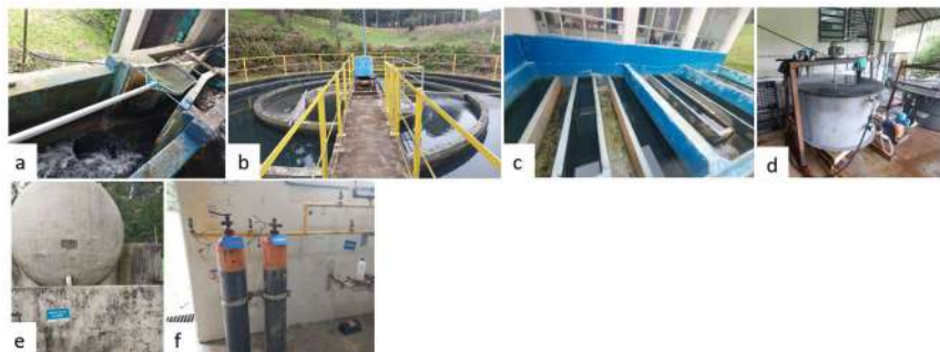
Figura 23: Registros fotográficos das estruturas da ETA: a) Calha Parshall; b) Floculador e decantador; c) Filtro; d) Tina de carvão ativado; e) Local de armazenamento do Sulfato de Alumínio; g) Cilindros de cloro.
