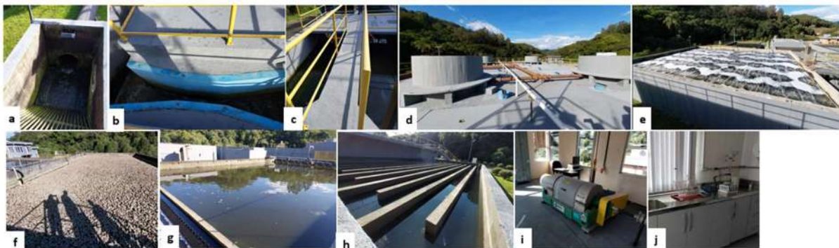
Figura 39: Registros fotográficos da Estação de Tratamento de Esgoto: a) Grade grosseira; b) Calha Parshall; c) Desarenador; d) Reator anaeróbico; e) Filtro biológico; f) Filtro biológico que não estava em operação; h) Desinfecção; i) Centrífuga; j) Laboratório.
