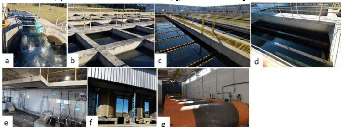
Figura 19: Registros fotográficos das estruturas da ETA: a) Calha Parshall; b) Floculador; c) Decantador; d) Filtro; e) Tina de carvão ativado; f) Local de armazenamento do PAC; g) Cilindros de cloro gás.
