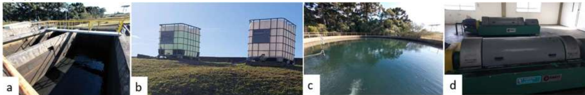
Figura 20: Registros fotográficos das estruturas da ETA: a) Decantador; b) Tanques de polímero; c) Equalizador; d) Prensa.
