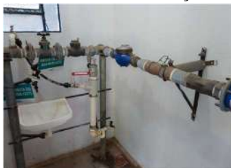
Figura 30: Sistema de desinfecção do poço.
