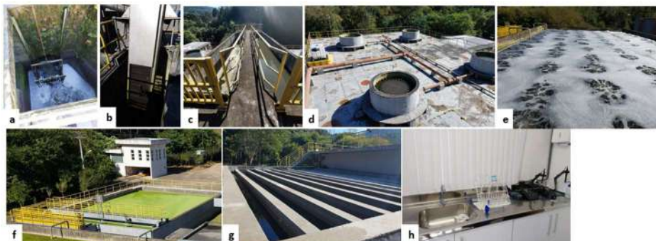
Figura 41: Registros fotográficos da Estação de Tratamento de Esgoto: a) Grade grosseira; b) Cremalheira; c) Desarenador; d) Reator anaeróbico; e) Filtro biológico; f) Decantador; g) Desinfecção; h) Laboratório.
