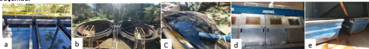
Figura 14: Registros fotográficos das estruturas da ETA: a) Decantador; b) Adensador; c) Equalizador; d) Prensa; e) Caçamba.
