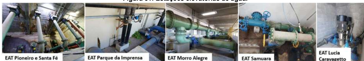
Figura 31: Estações elevatórias de água.
